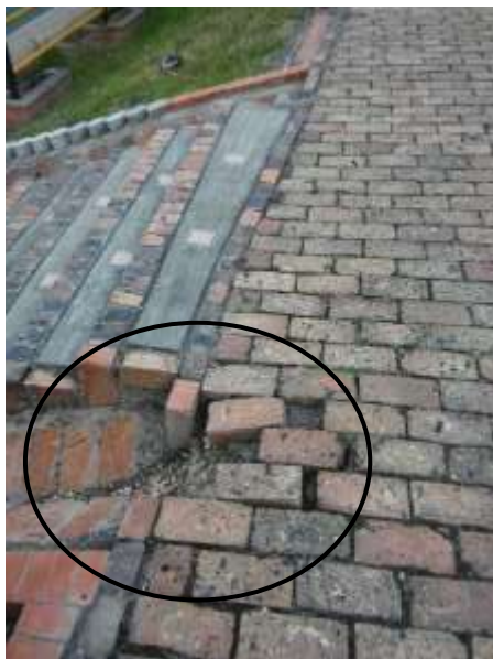
Figura 32. Adoquín en mal estado.
