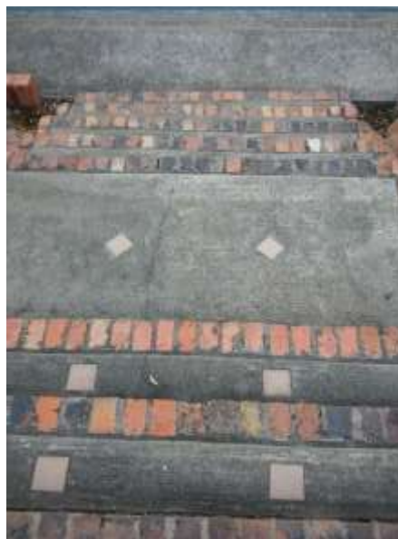
Figura 33. Escalera de acceso en mal estado.
