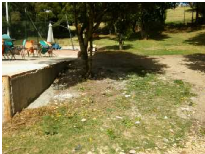
Figura 39. falta de acceso a la zona de estar.
