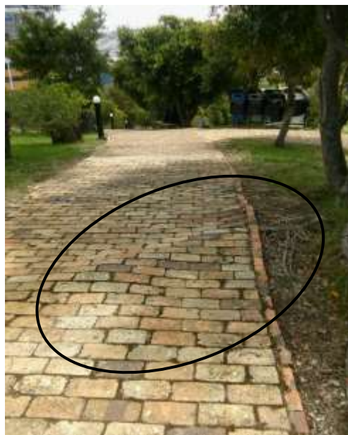
Figura 51. Adoquín erosionado por raíz de árbol.
