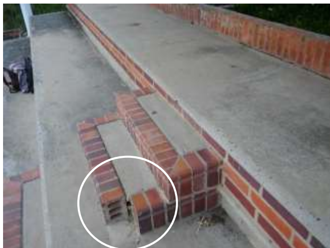
Figura 40. gradería en estado regular.
