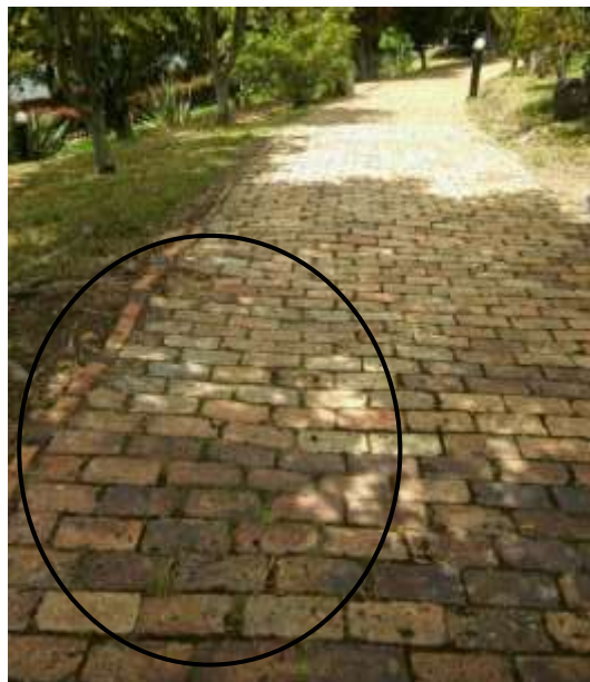
Figura 50. Adoquín en mal estado.
