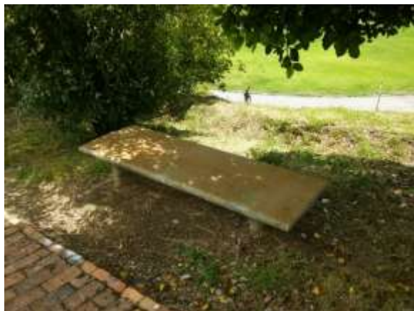
Figura 53. Banco en mal estado y sin acceso.
