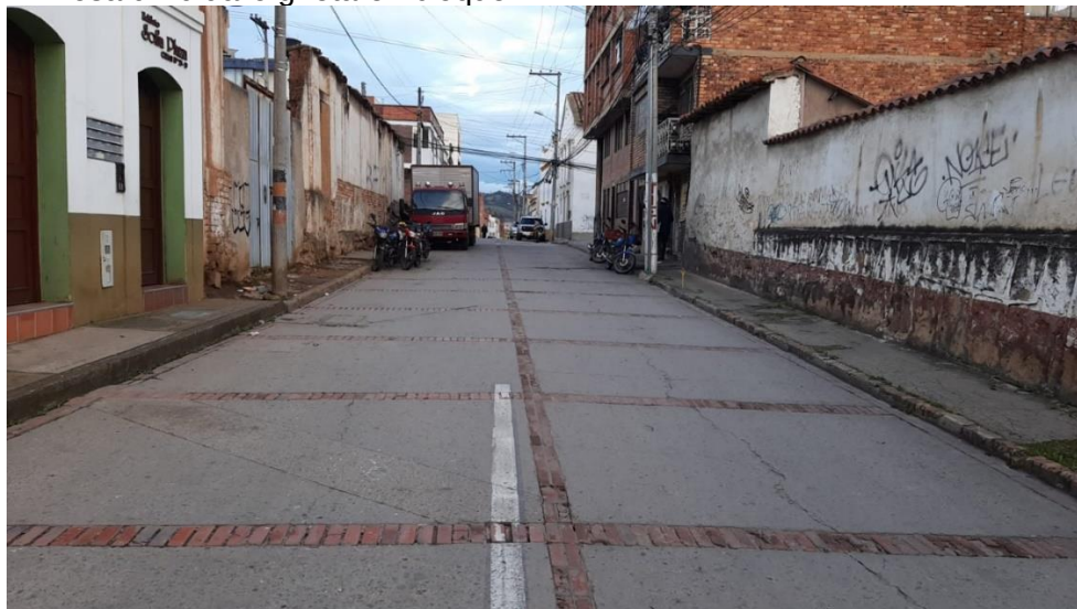
Figura 12. Losa dividida o grieta en bloque.
