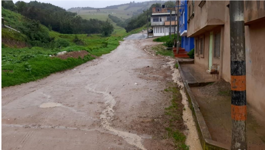
Figura 17. Erosión de cunetas
