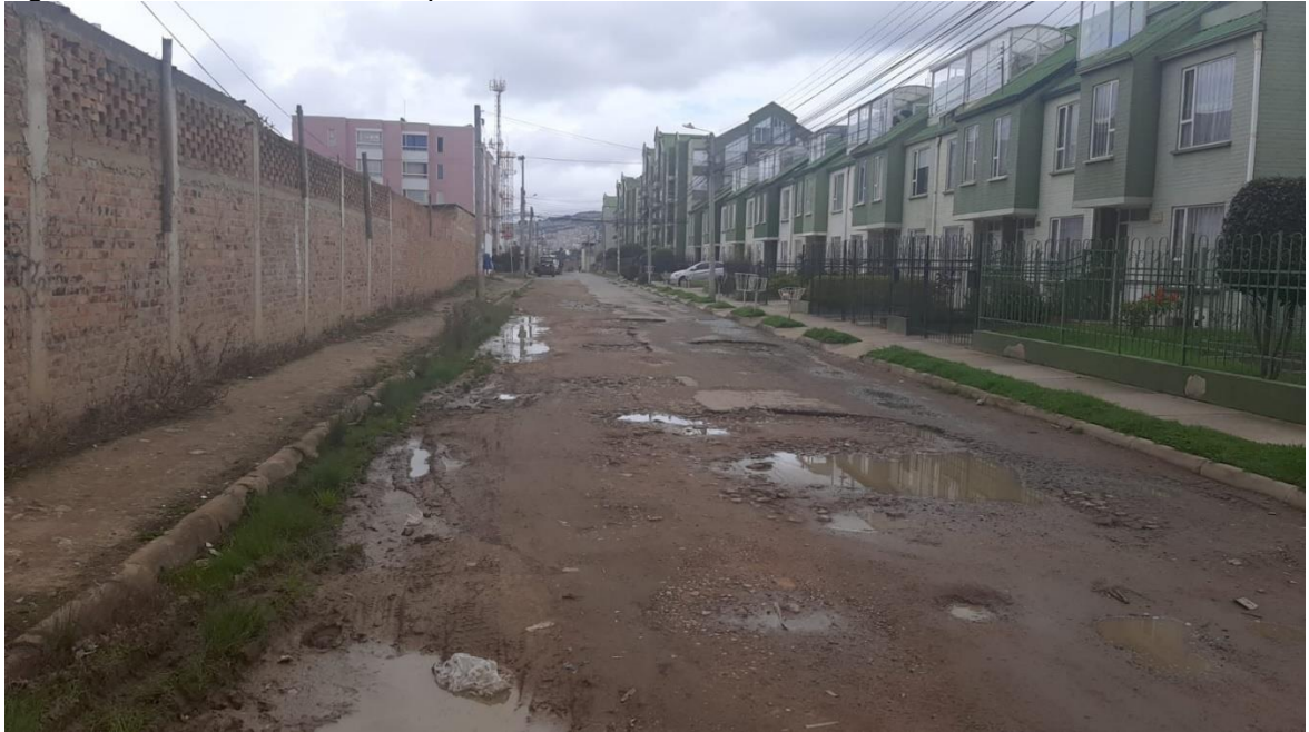
Figura 15. Infiltración en la capa de rodadura.
