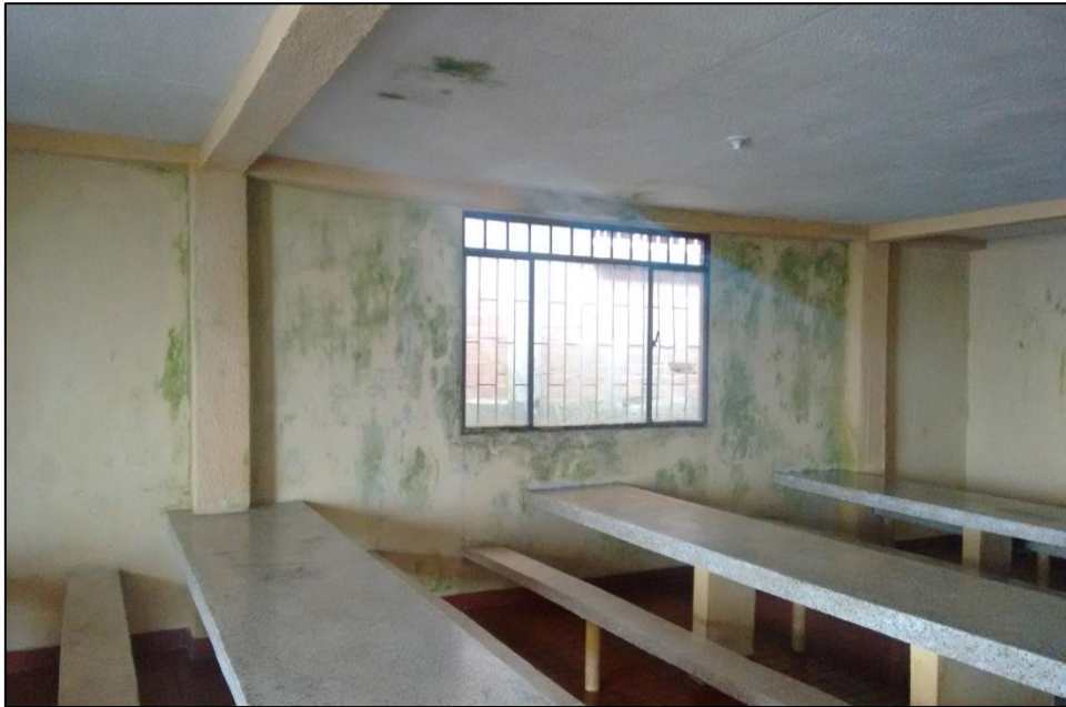
Ilustración 12. Manifestaciones patológicas, cara interna de la fachada lateral izquierda del Restaurante escolar Centro poblado Cruces
