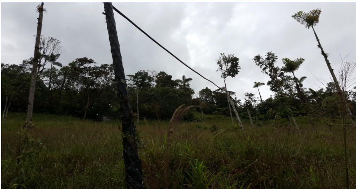
Ilustración 79. Tubería aérea Acueducto – Vereda JUNIN
