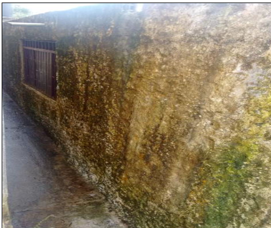
Ilustración 11. Manifestaciones patológicas, fachada lateral izquierda del Restaurante escolar Centro poblado Cruces
