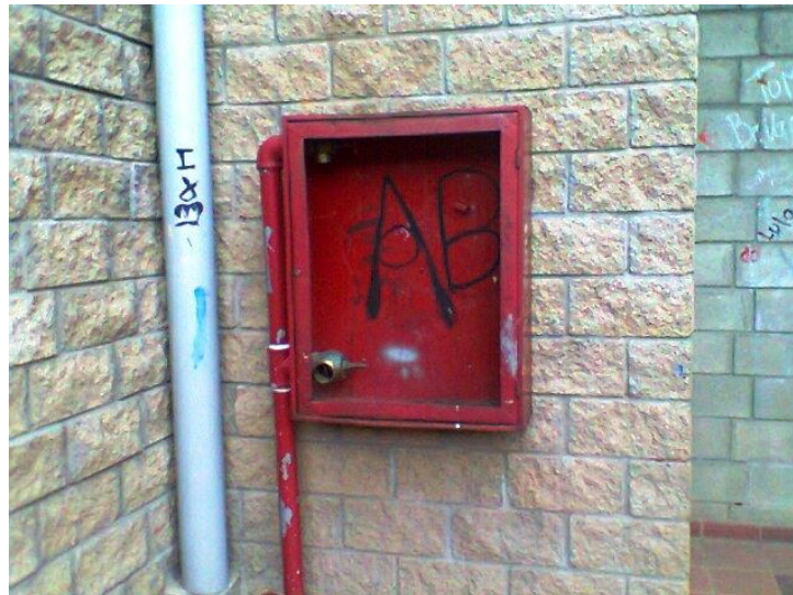
Sistema de seguridad (extintores)
