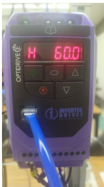
FIGURA 52: Variador puesto en marcha con 60Hz. Autoría propia
