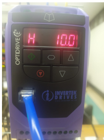
FIGURA 49: Variador puesto en marcha con 10Hz. Autoría propia
