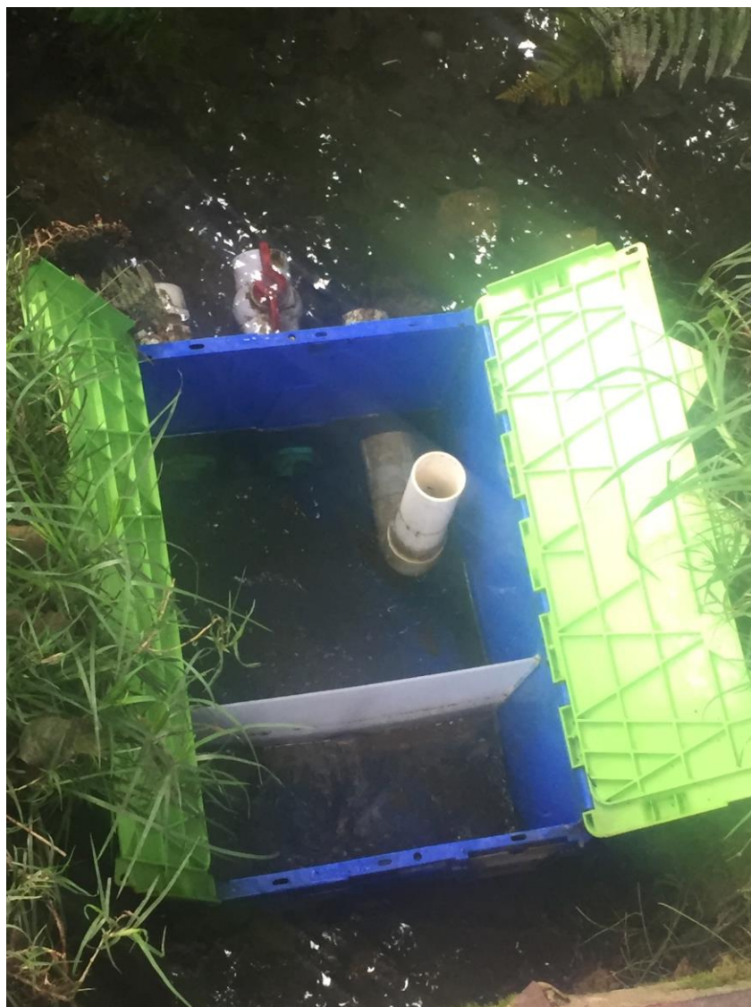
Figura 8 Ejemplo Estructura Reguladora de Caudal
