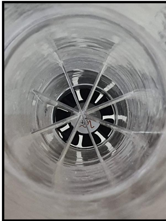
Figura 34. Enderezador de flujo al interior del ducto
