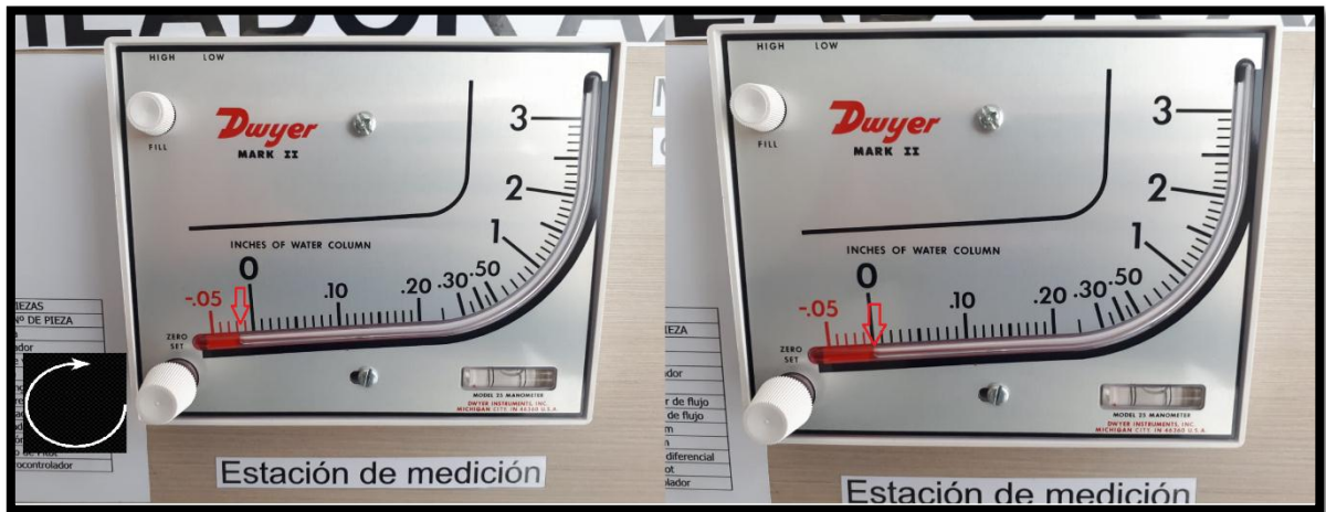
Figura 8. Calibración del líquido del manómetro en el valor 0. Giro de la perilla set.
