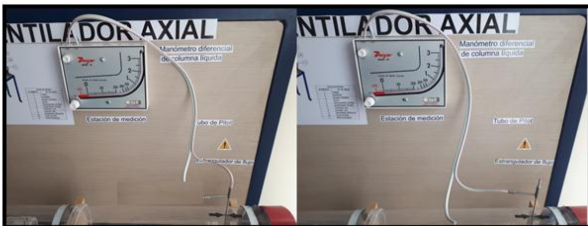
Figura 9. Conexión del tubo de Pitot al manómetro.
