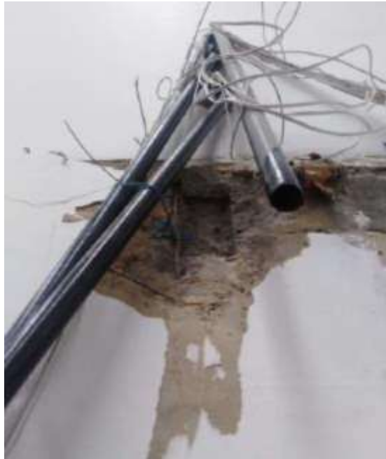
Ilustración 5 Punto de Falla
