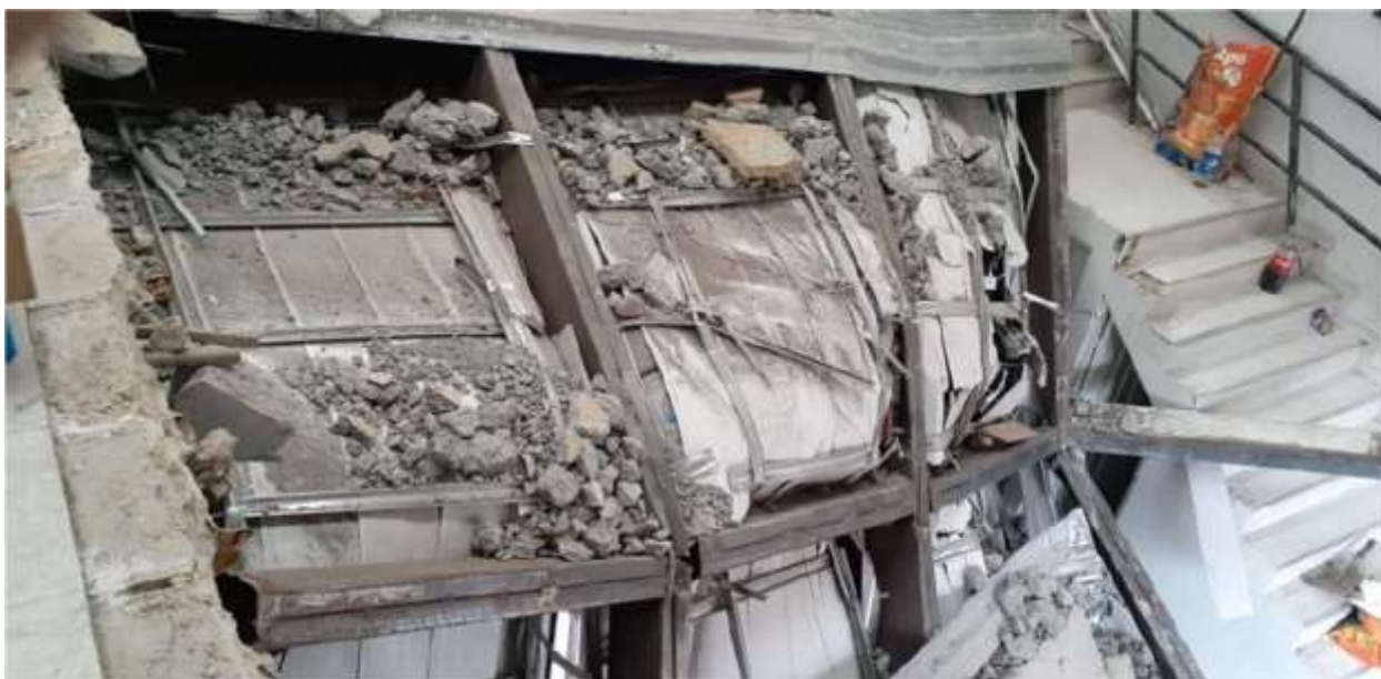
Figura 3. Zona del colapso
