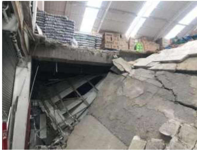
Figura 1. Losa de entrepiso. Falla por sobrepeso
