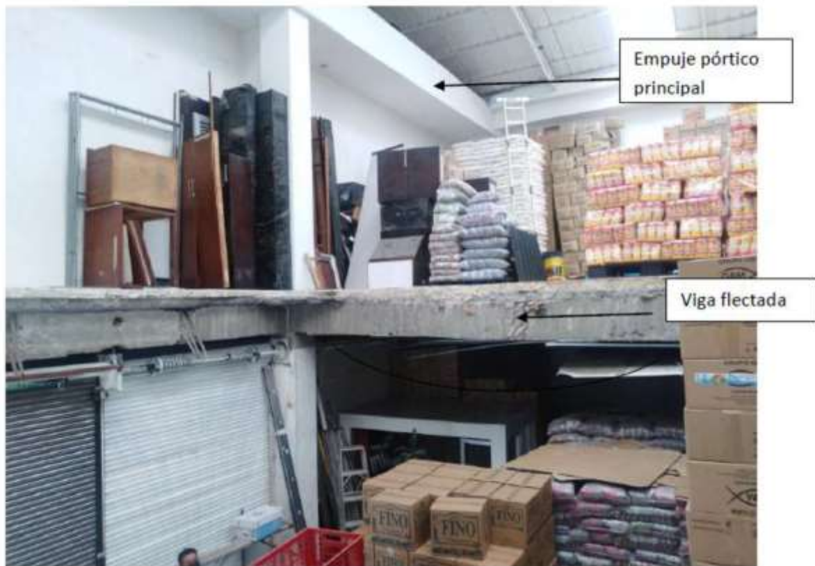
Ilustración 6 Vigas Afectadas Ejes J y 8
