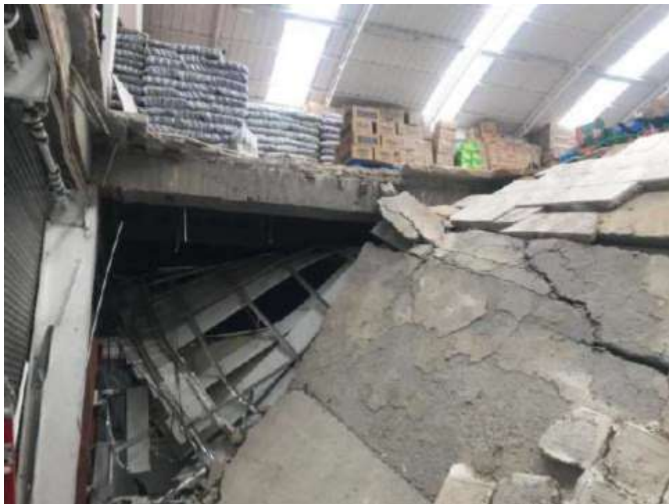
Ilustración 3 Sección Estructura Fallada
