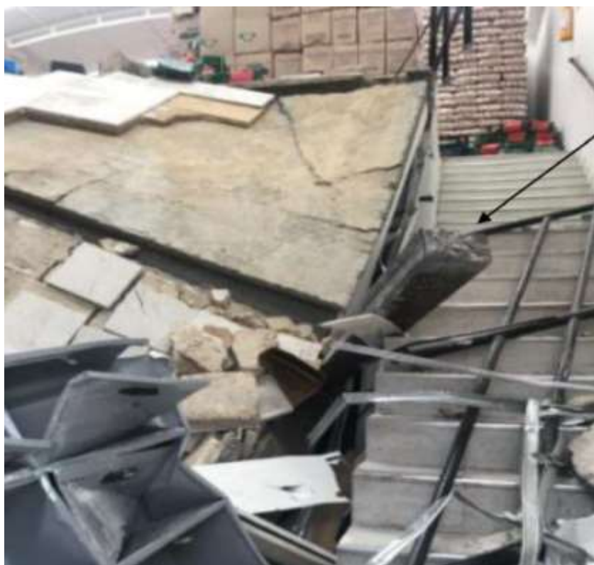
Ilustración 4 Perfil Metálico Fallado
