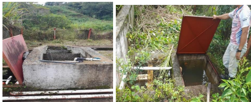
Figura 18. Infraestructura de suministro de agua potable vereda Suarez y Ulloa.
