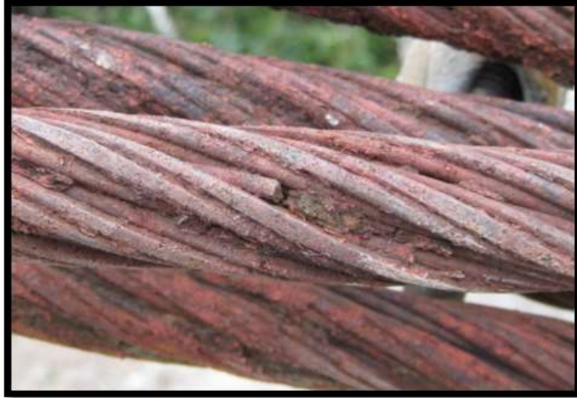
Figura 18: Rotura de alambres Fuente: los autores.
