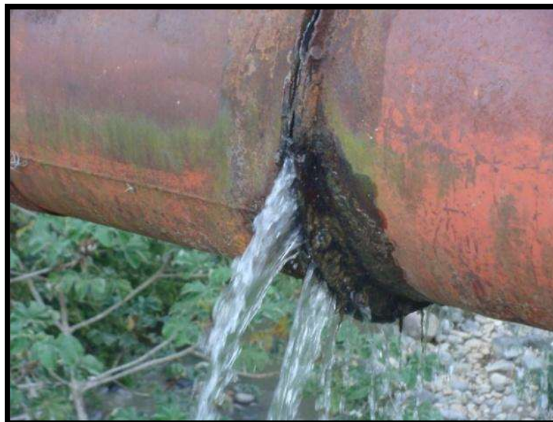
Figura 16: Oxidación de tubería y desgaste neopreno
