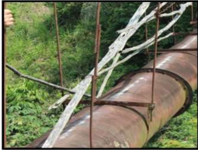
Figura 25: Detalle unión de tensores a la tubería Fuente: los autores.
