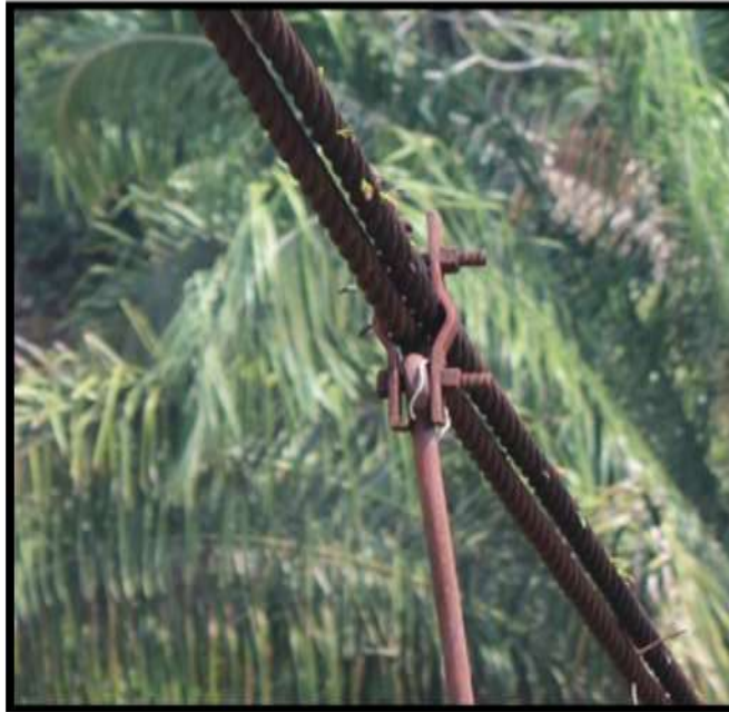
Figura 24: Detalle perros de amarre de los pendolones a los cables Fuente: los autores.
