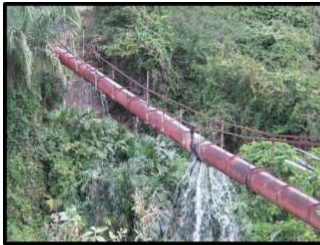
Figura 1: Fugas de agua en el paso elevado Fuente: los autores.
