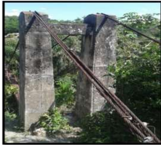
Figura 21: Paso de cable por el pórtico en concreto Fuente: los autores.
