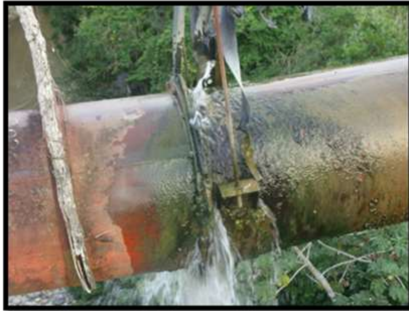
Figura 15: Detalle fuga de agua en la tubería por desgarre laminar
