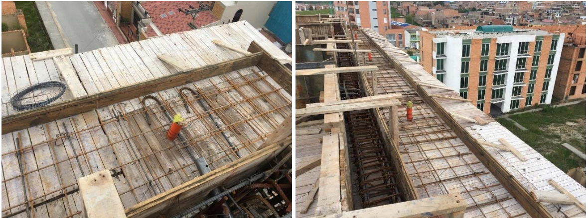
Ilustración 24: Ganchos de Refuerzo para Voladizo en Placa N°6 de Entrepiso Edificio Río Parque Residencial
