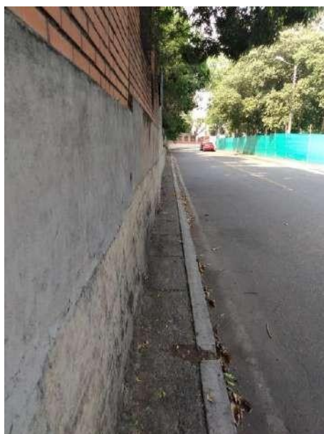
Figura 1. Andenes inaccesibles y deteriorados a lo largo del sector de estudio.
