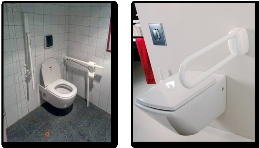
Figura 32. Fotografías de Sanitarios con Barras de Apoyo.
