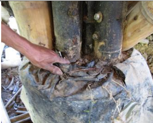
Pudrición de elementos por humedad
