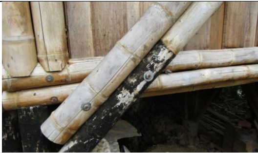
Elemento estructural (Riostra) con problemas de fisuración.
