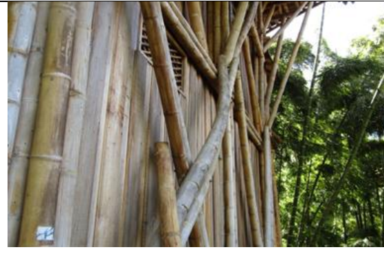
Elemento sometido a compresión alabeado.
