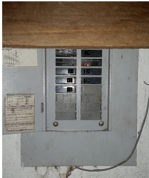
Figura 20. Caja de distribución principal de energía ubicada en la primera planta Fuente: Autor
