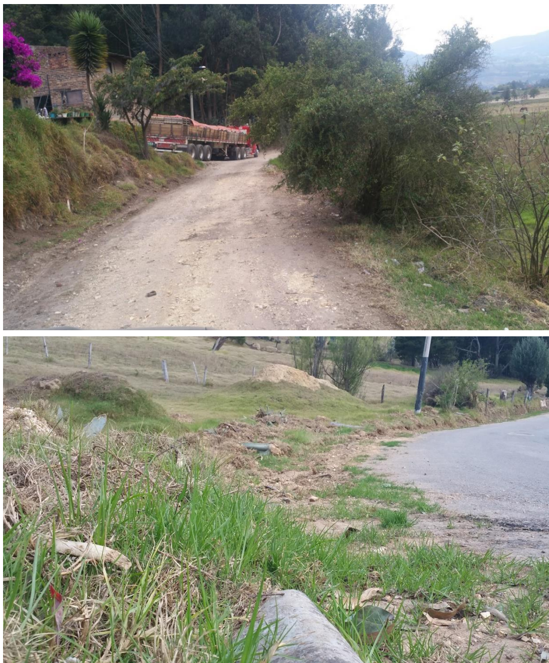
Fotografía 4. Patologías en el pavimento de la vía Rincón de las Campanas
