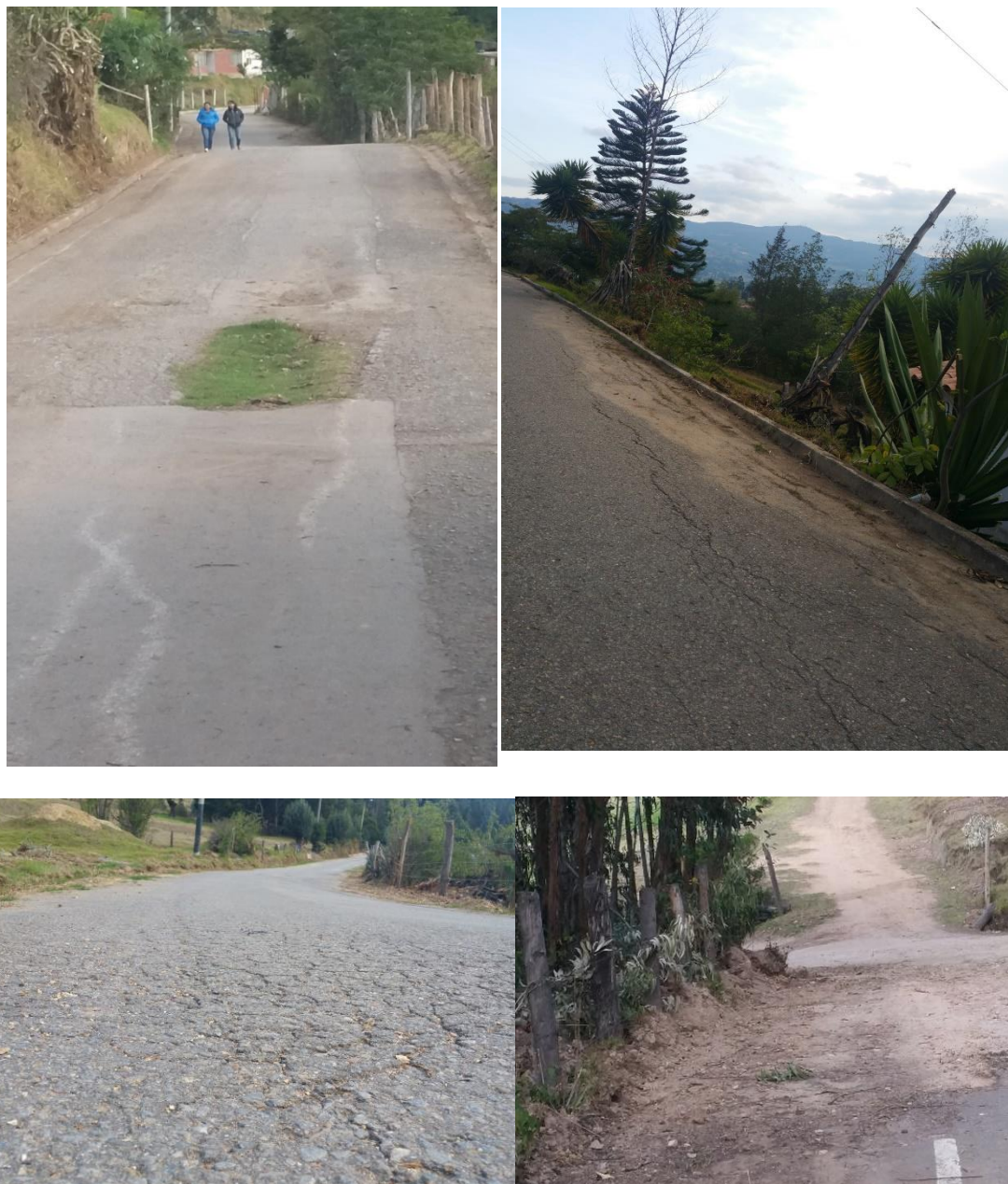
Fotografía 1. Patologías en el pavimento de la vía Rincón de Suazapawa.
