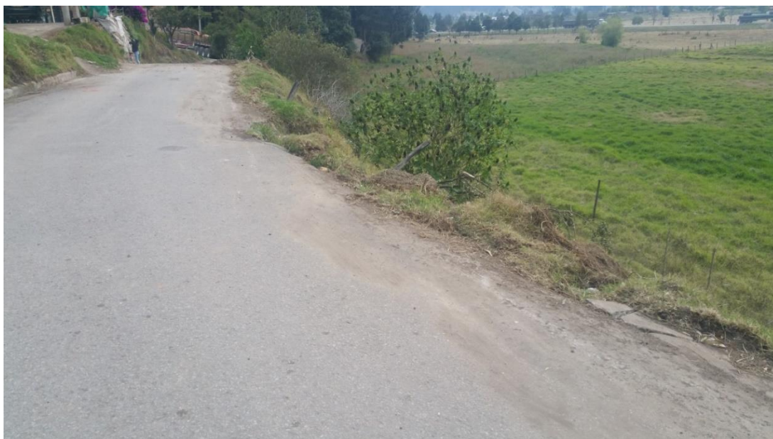
Fotografía 2. Pérdida de la banca K0+680 Vía Rincón de Suazapawa.
