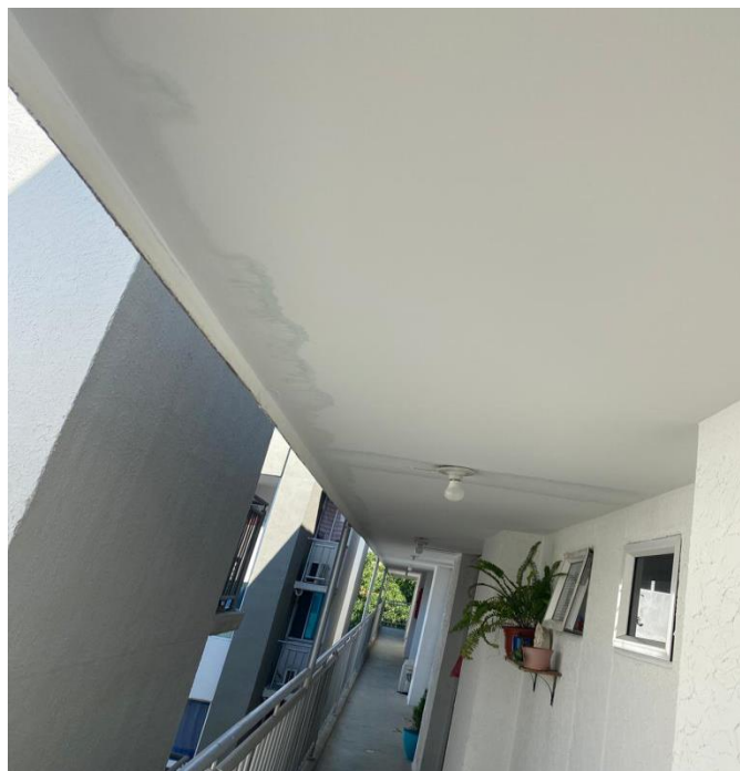
Figura 24. Registro fotográfico humedad en pasillos
