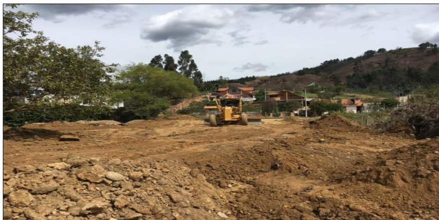
Imagen 3 Conformación de botadero
