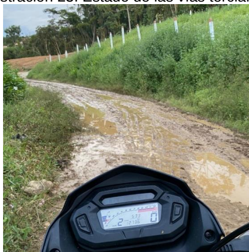
Ilustración 23. Estado de las vías terciarias
