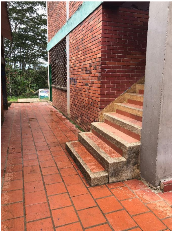
Figura 29. Circulaciones verticales que obstruyen el flujo peatonal.
