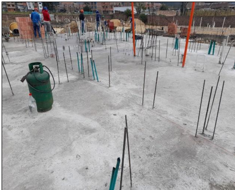
Figura 7. Placa de contrapiso.
