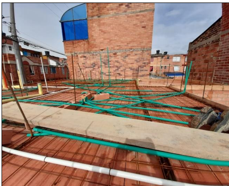
Figura 18. Distribución red eléctrica torres de Guadalupe.
