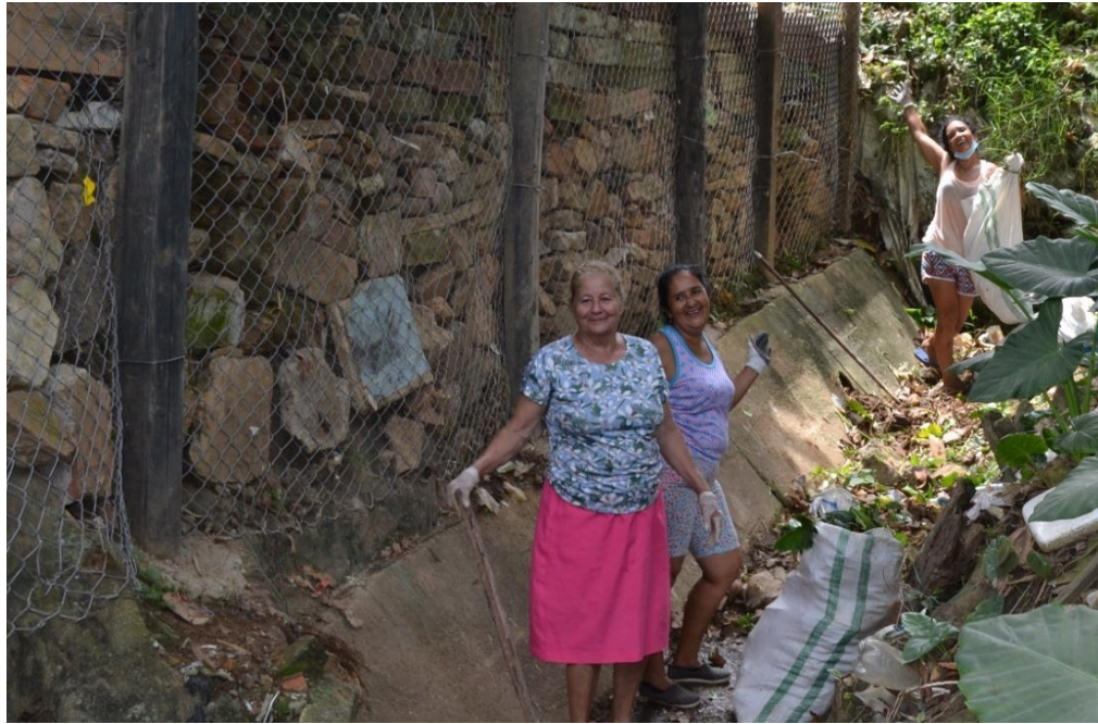
Figura 29. Cimentación con escombros y parales. Fuente: Archivo propio.
