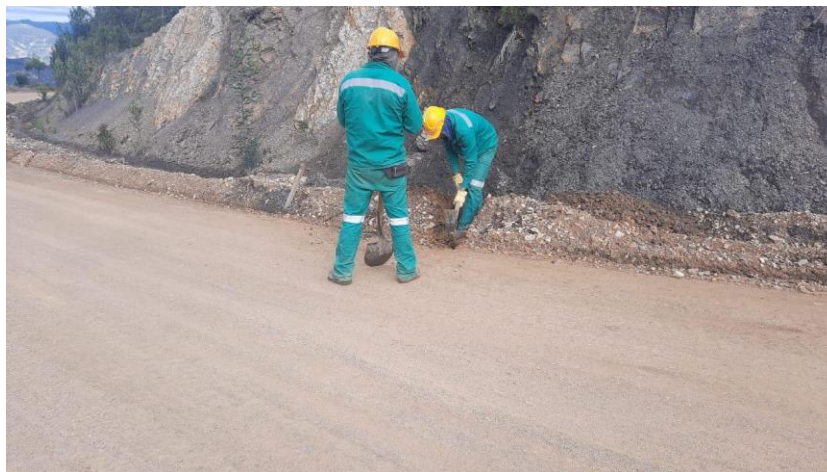
Figura 28. Presencia de colchón por infiltración subterránea.
