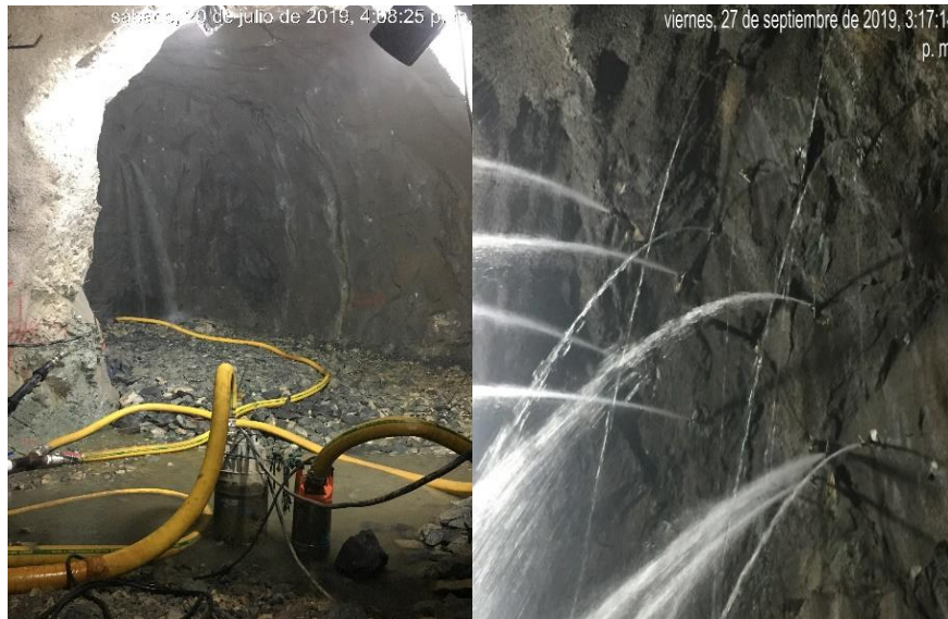
Ilustración 31 Agua filtrando por el macizo rocoso (Autor: Fuente Propia)
