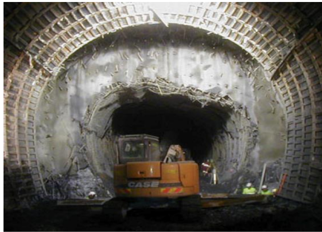
Ilustración 27 Falla squeezing en un túnel (DI_Cosas, 2015)
