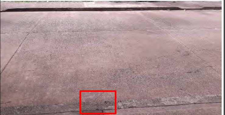
Imagen No. 071T. La grieta termina en el punto medio de la placa en el borde aldaño al sardinel. Una grieta de menor dimensión continua en sentido longitudinal.
