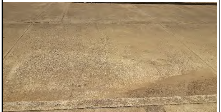
Imagen No. 031T. Presencia de grietas longitudinales y transversales.
