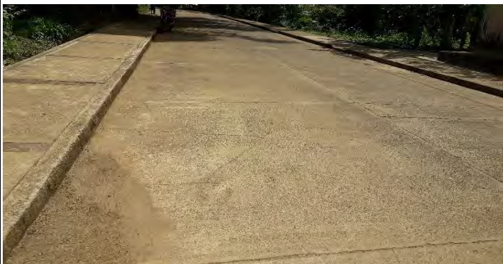
Imagen No. 031L. Pérdida del macrotexturizado de la supercife, grietas longitudinales y transversales.
