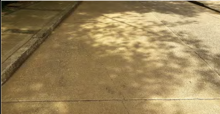
Imagen No. 071L. La grieta longitudinal que viene atravesando de la losa a losa termina cerrando en esta placa
