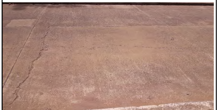
Imagen No. 051T. La grieta transversal es de mayor ancho y pudo haber presentado por demoras en el corte de la junta aladaña.
