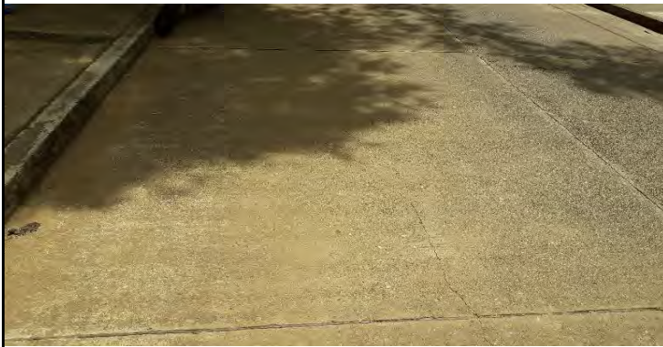
Imagen No. 061L. La grieta longitudinal atraviesa la losa y conecta con las grietas de las losas vecinas a las juntas transversales.
