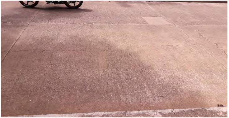
Imagen No. 061T. Vista de la grieta longitudinal. Se puede inferir que se asocia a la causa de las grietas longitudinales de las placas vecinas.
