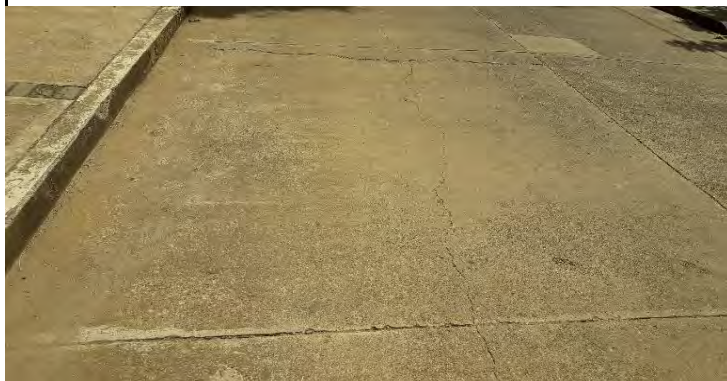
Imagen No. 051L. La grieta longitudinal atraviesa la losa y conecta con las grietas de las losas vecinas a las juntas transversales.
