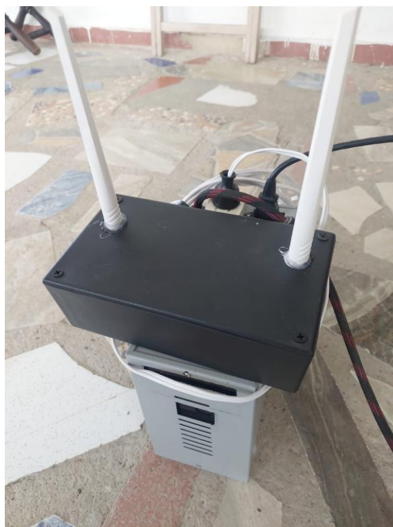
Ilustración 56 - Instalación Módulo servidor Fuente: autoría propia
