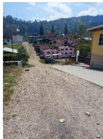
Vía zona residencial sin pavimentar, en estado regular
