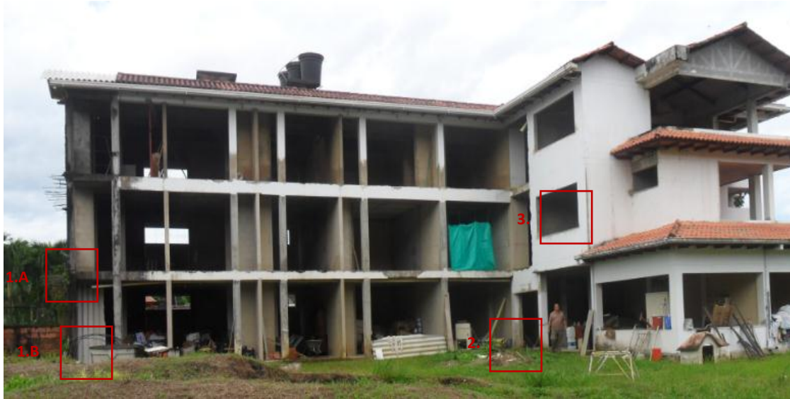
Grafico 57 Fotografía de la fachada lateral del edificio Vanguardia denotando los daños por humedad .
