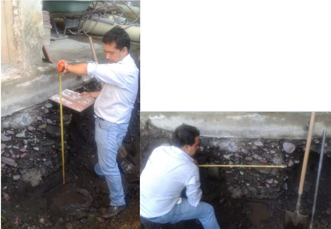
Fotos 52 y 53: Apique para medir la zapata
