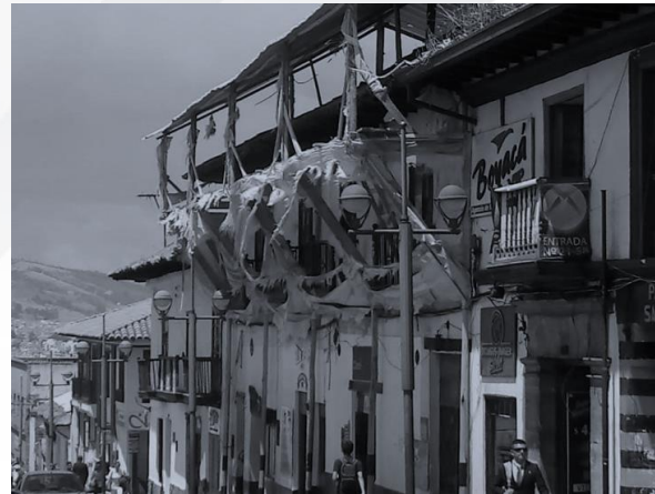
Figure 1 construcción en deterioro tomada de(propia)
