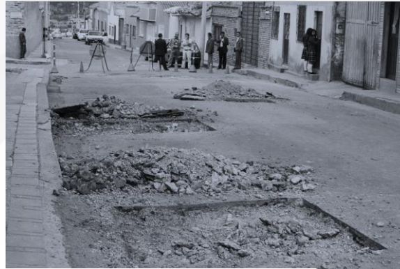
Figure 5 sistema vial en deterioro tomada de(elaboración propia)
