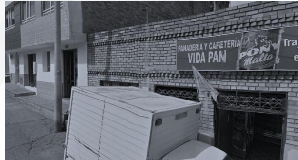
Figure 4 construcción en deterioro tomada de(propia)
