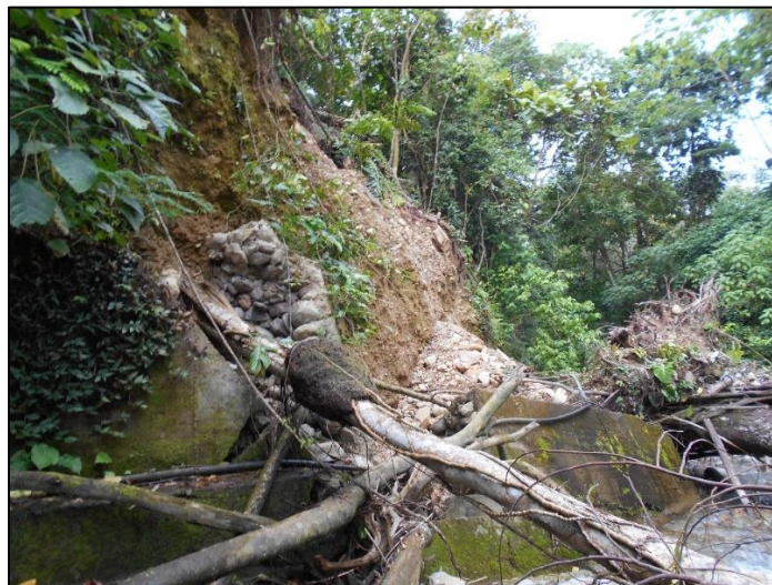
Figura 1-2. Daños ocasionados por el caño buque, gavión destrozado y árbol caído. Fuente: Autor
