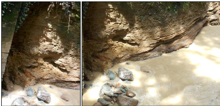
Figura 1-1. Lluvias afectan estribo del puente de la Av. 40 Cerca de la Cll. 15. Fuente: Autor.
