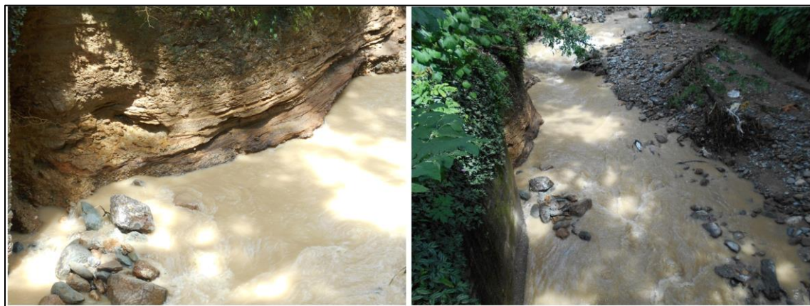
Figura 4-33. Socavación en estribo del puente de la Av. 40 cerca a la calle 15. Fuente: Autor
