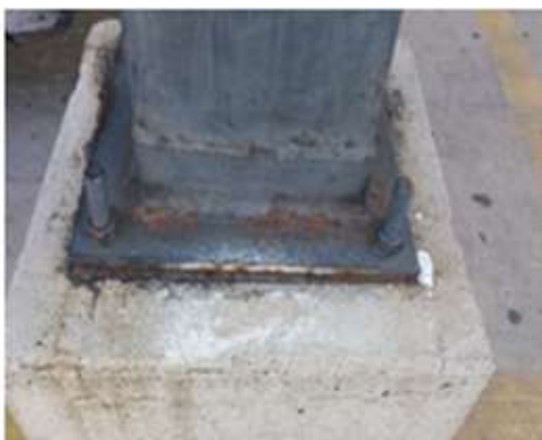
Figura 9. Afectación de la platina de anclaje en la estructura metálica para el parqueadero. Por Bueno Agudelo, Y. P. y Padilla Pacheco, Y. V. (2018). Se evidencia el grado de oxidación y la falta de mantenimiento en los sistemas de anclaje de la estructura metálica sobre pedestal de concreto entre puestos de parqueadero 45 y 46. Estudio Patológico Edificio de Parqueadero Conjunto Residencial Altos del Parque, Cali- Valle . Universidad Santo Tomás. Bogotá, Colombia
