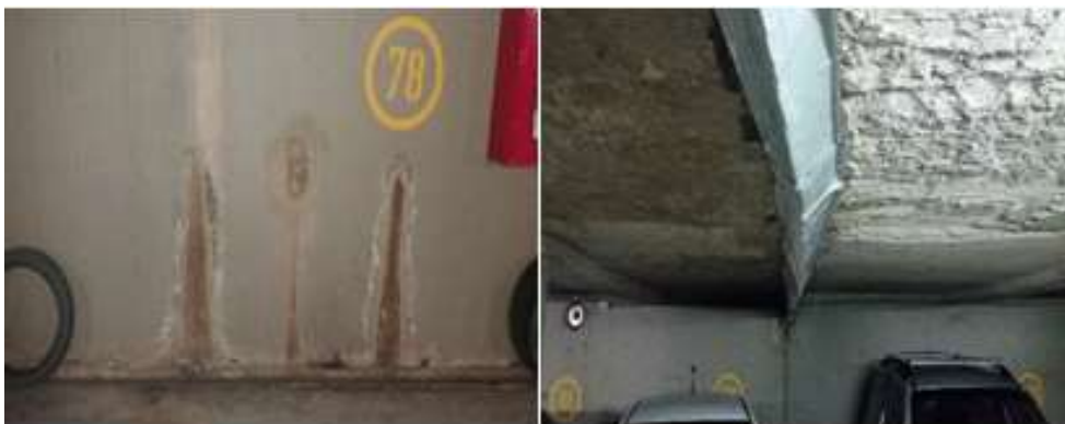
Figura 13. Lesiones en el sótano del parqueadero. Por Bueno Agudelo, Y. P. y Padilla Pacheco, Y. V. (2018). Localización e identificación de humedades en muro y desprendimiento del recubrimiento en placa en el sótano del parqueadero. Estudio Patológico Edificio de Parqueadero Conjunto Residencial Altos del Parque, Cali- Valle. Universidad Santo Tomás. Bogotá, Colombia.
