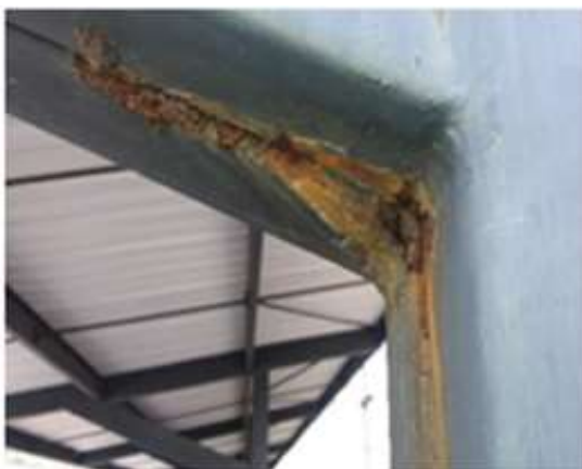
Figura 10. Afectación por oxido de los perfiles de la estructura metálica para el parqueadero. Por Bueno Agudelo, Y. P. y Padilla Pacheco, Y. V. (2018). Se evidencia corrosión en perfiles de estructura metálica para cubierta de parqueadero sobre pedestales de puestos de parqueo 45 y 46. Estudio Patológico Edificio de Parqueadero Conjunto Residencial Altos del Parque, Cali- Valle. Universidad Santo Tomás. Bogotá, Colombia.
