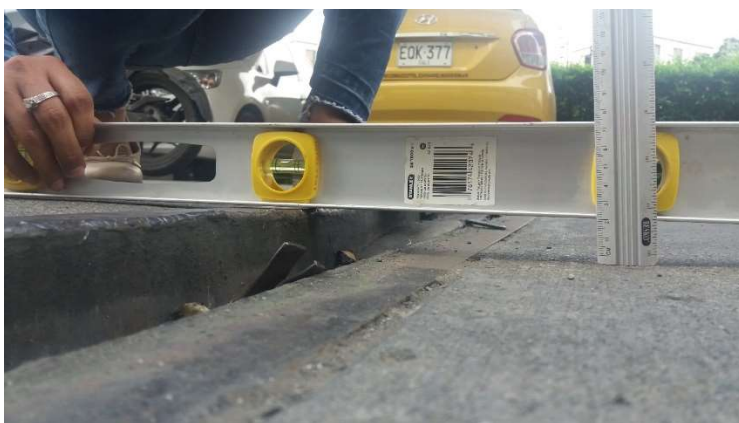
Figura 6. Asentamiento junta de construcción, losa de parqueadero a nivel
