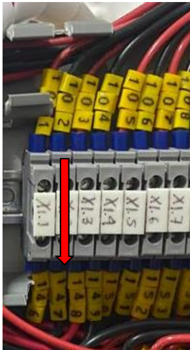
Figura 62. Conexión entre líneas en una misma bornera.
