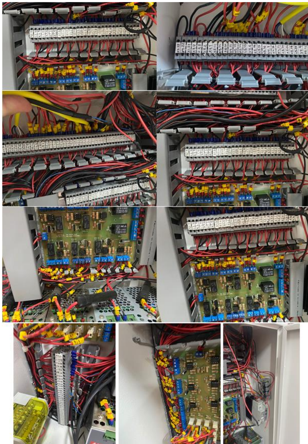
Figura 26. Problemas de cableado en planta 4.
