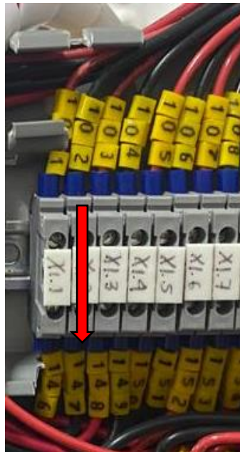
Figura 3. Conexión entre líneas en una misma bornera.
