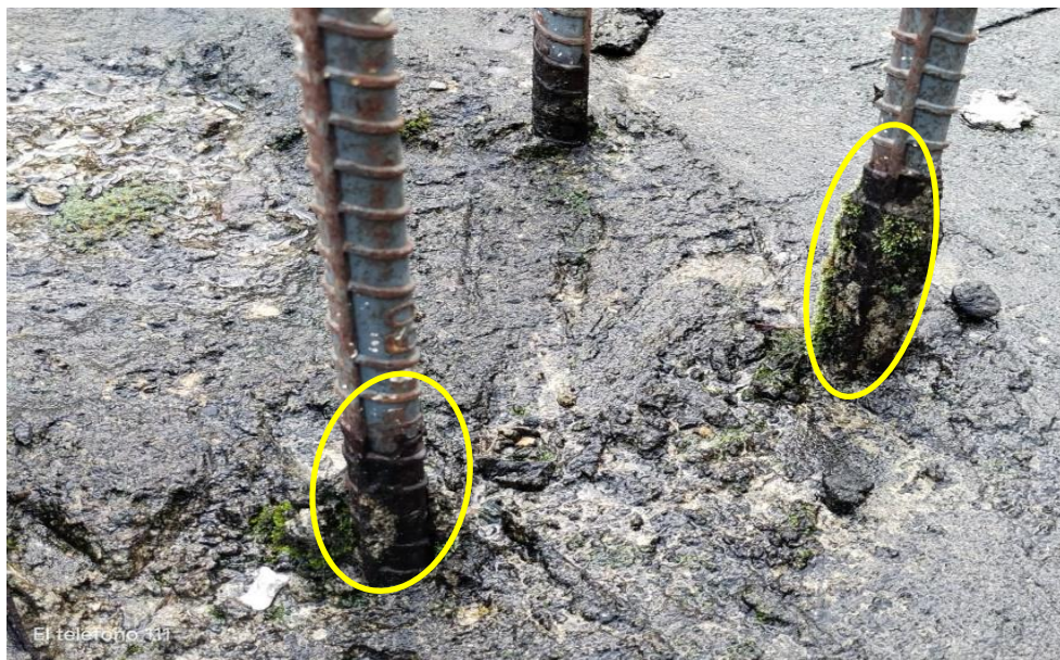
Figura 30. Presencia de Musgo en acero de refuerzo
