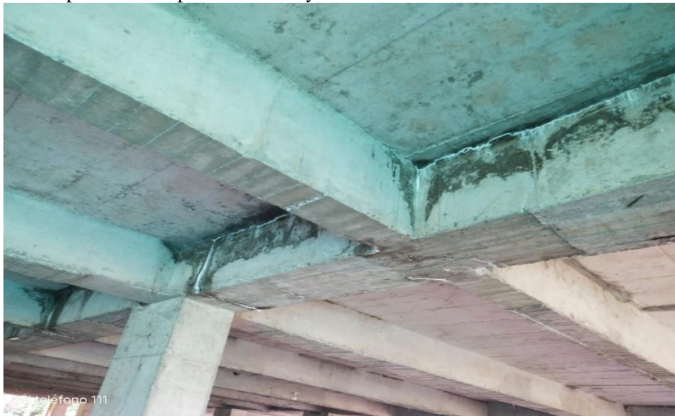
Figura 20. Placa entrepiso afectada por filtraciones y micro fisuras
