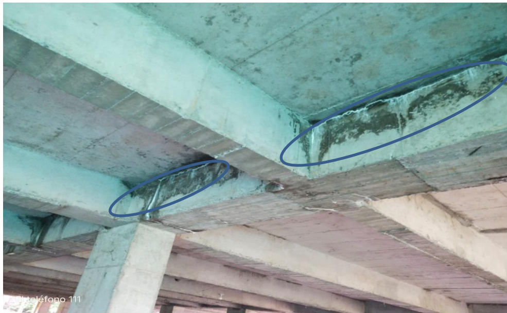
Figura 29. Humedad y Eflorescencia
