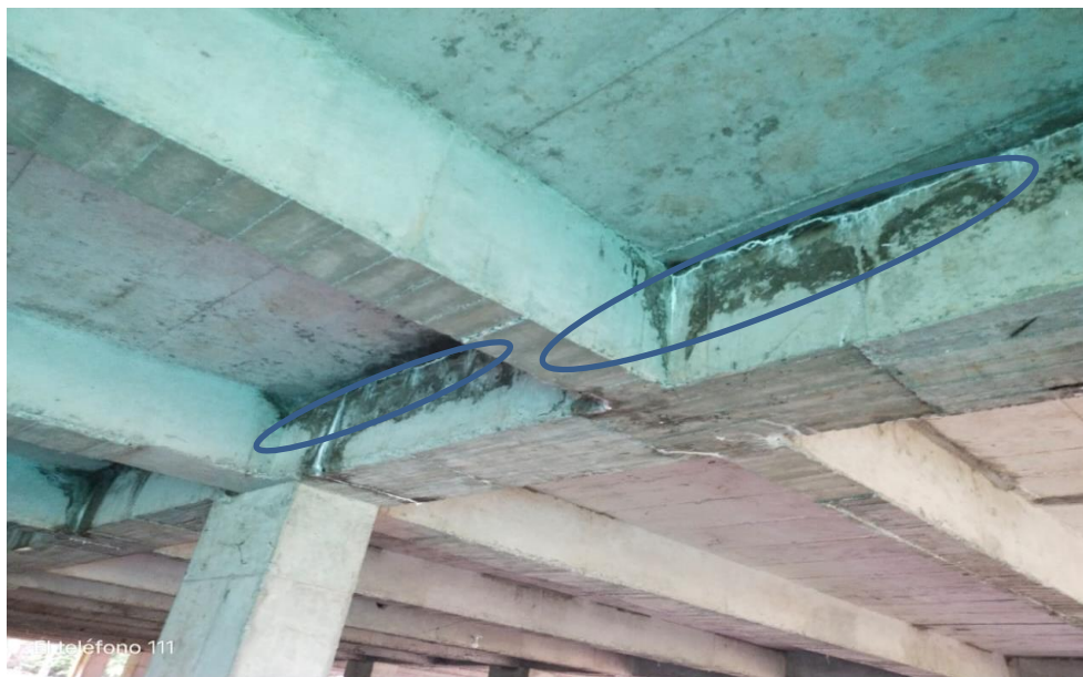
Figura 27. Humedad y Eflorescencia
