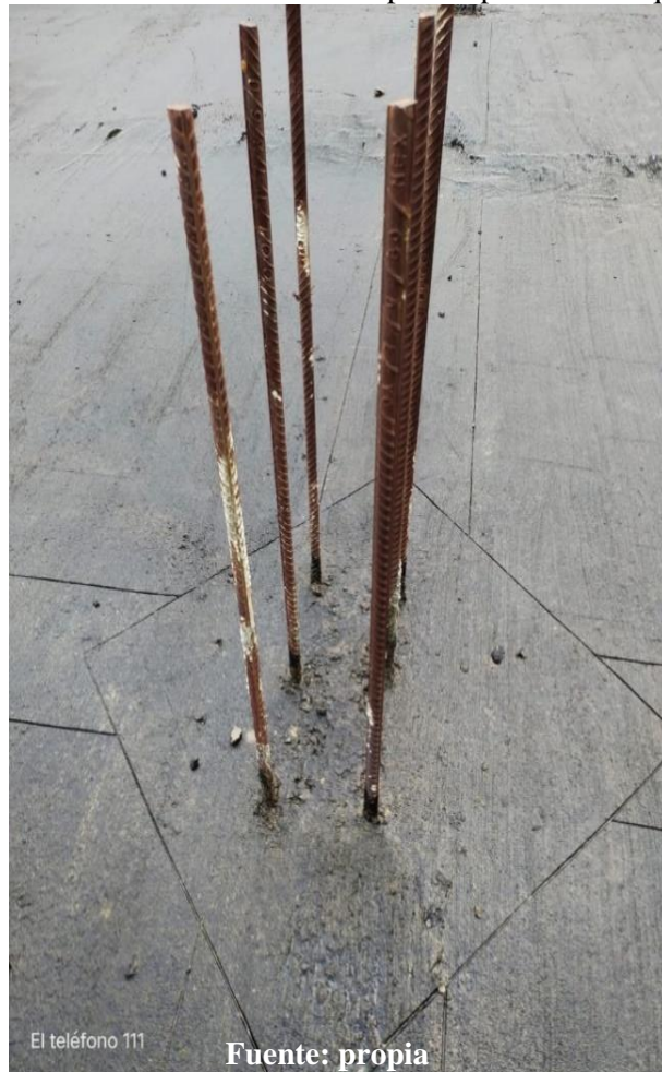
Figura 24. Oxidación y moho aceros en las columnas del primer piso de arranque
