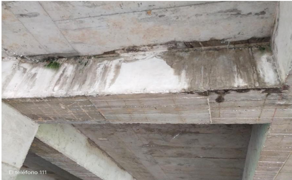
Figura 19. Presencia de humedad de placa entrepiso por posibles fisuras
