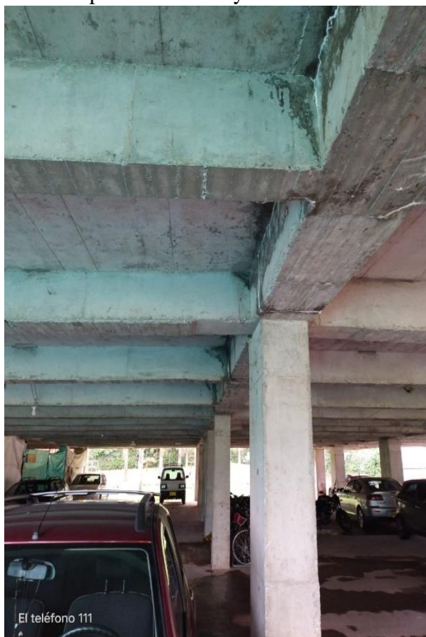
Figura 18. Placa entrepiso afectada por filtraciones y micro fisuras
