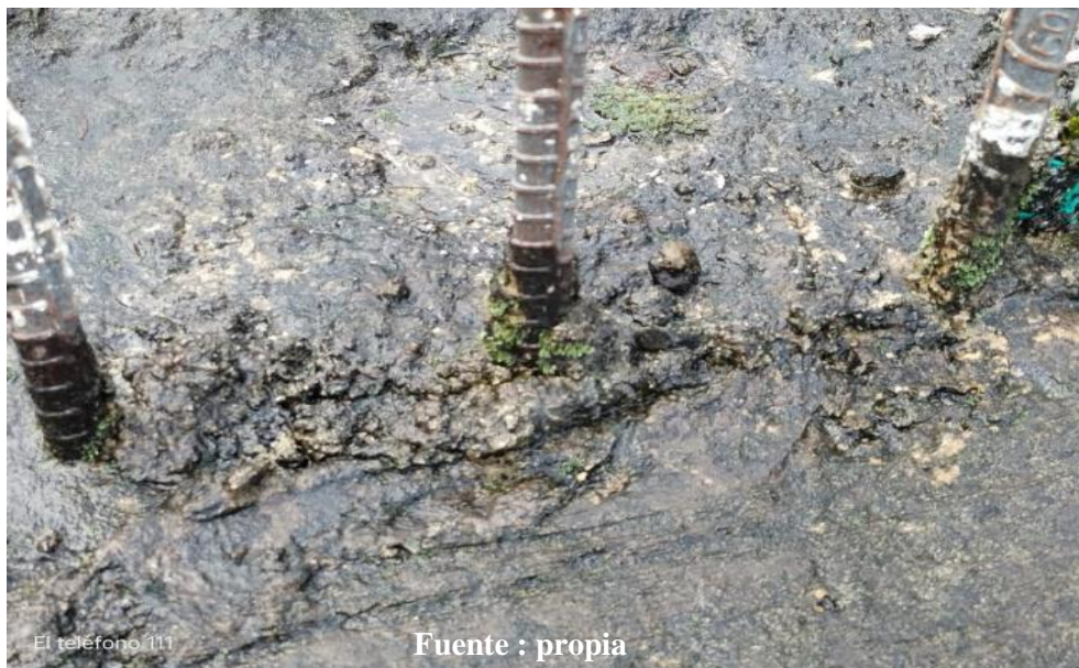
Figura 22. Oxidacion y moho en los aceros de las columnas del primer piso
