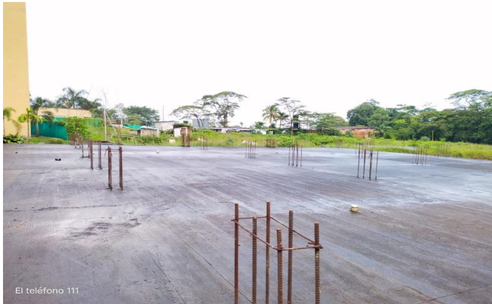
Figura 28. Estado de la placa de entrepiso de la Torre de parqueaderos
