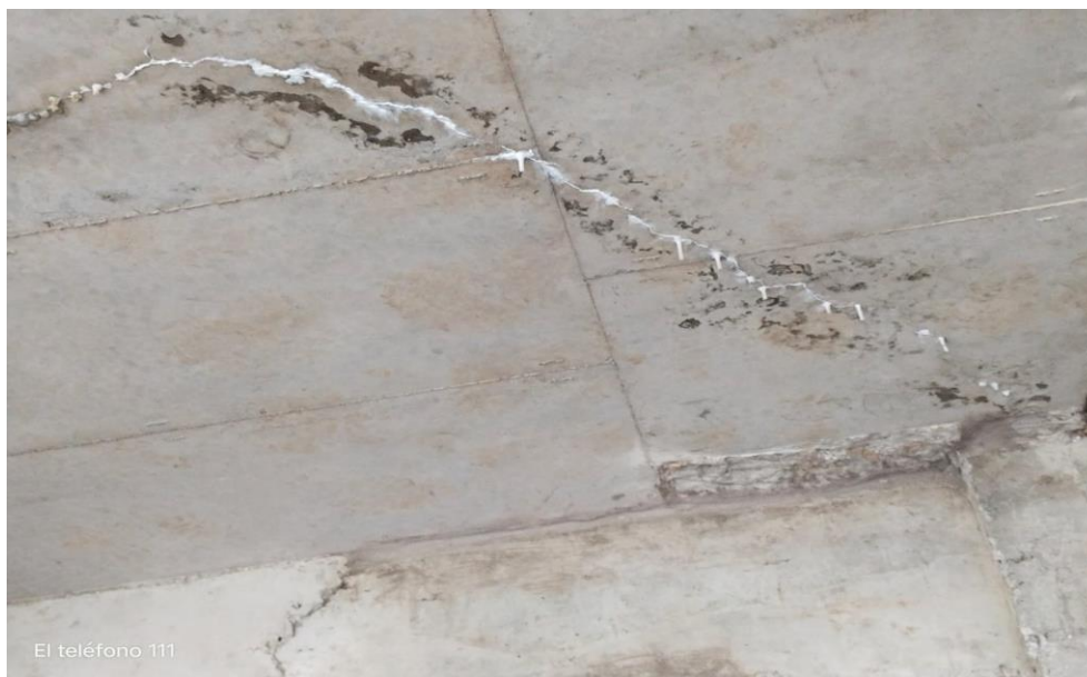
Figura 31. Fisuras con presencia de eflorescencia
