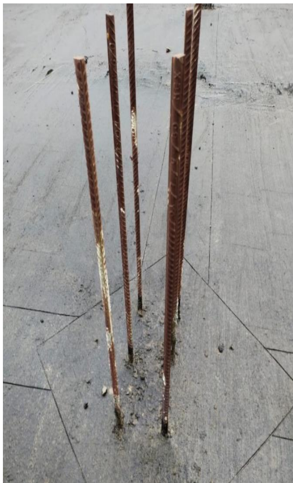
Figura 32. Oxidación en el acero de refuerzo
