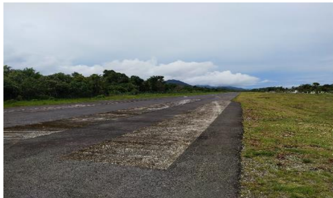
Ilustración 12: Estado actual de la pista ancho 15 m.
