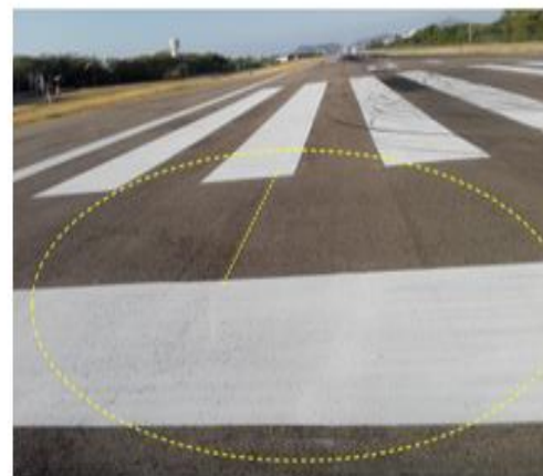
Cabecera 01, Fisuras longitudinales y transversales. Pulimiento de agregados.
