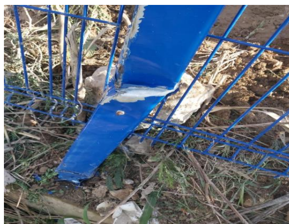
Ilustración 9: Aeropuerto Gustavo Rojas Pinilla - Cerramiento con afectación.
