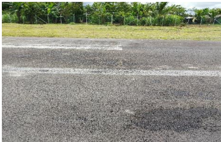
Ilustración 13: Empozamiento de agua en pista debido a la baja pendiente transversal.
