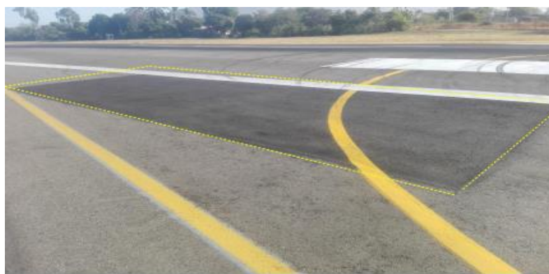
Calle de rodaje Bravo, Parcheo, fisuras longitudinales
