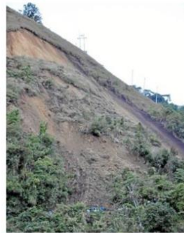
Figura 31. Vista panorámica, hacia Balsillas (al fondo), de la ladera potrerizada que se desestabilizó (MM-563), y sepulchro a los vehículos que allí esperaban paso por las labores de mantenimiento vial, de la parte inferior. Fuente: Lapatria.com (31-12-2012).
