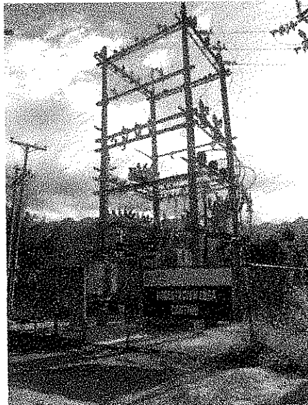
Figura 34. Subestación Cantino EBSA. Fuente. Autor
