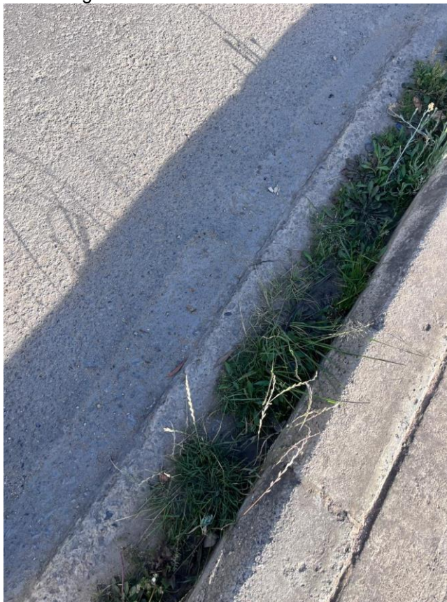
Figura 6. Estado de la cuneta existente.
