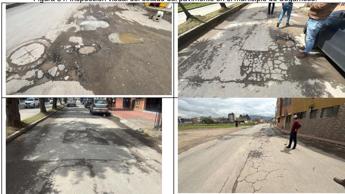
Figura 34. Inspección visual del estado del pavimento en el municipio de Sogamoso.
