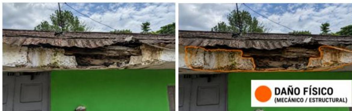
Figura 26. Patología deterioro de viga mixta por humedad y pérdida de adherencia (Centro de Villavicencio)
