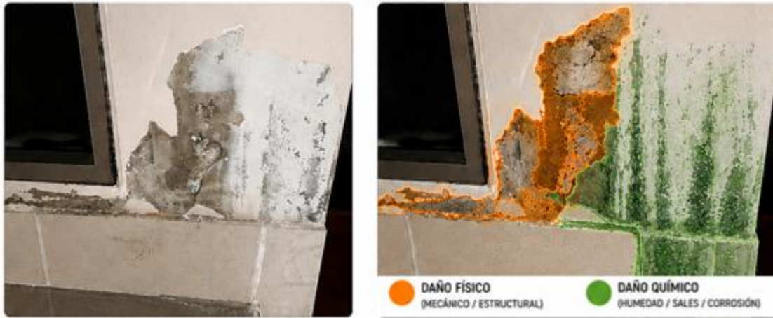
Figura 10. Patología de humedad por condensación (Suba, Bogotá)
