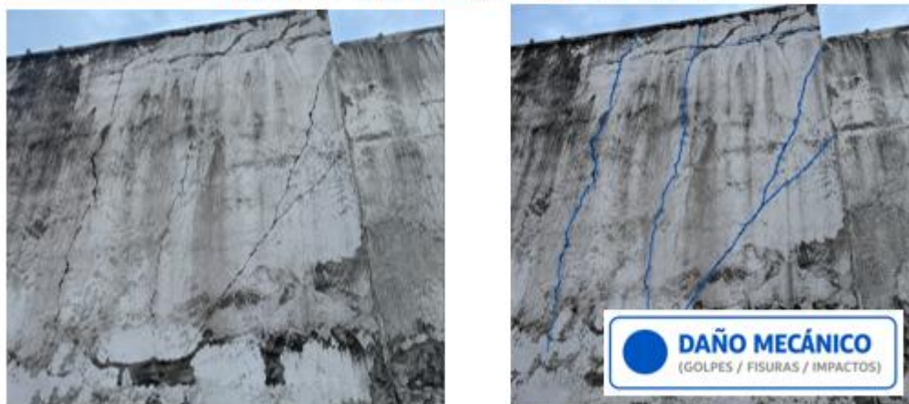
Figura 30. .Patología grietas longitudinales y diagonales en muro (La reserva, Villavicencio)
