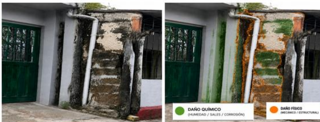
Figura 18. Patología deterioro de material por humedad y ataque biológico (Playa rica, Villavicencio)
