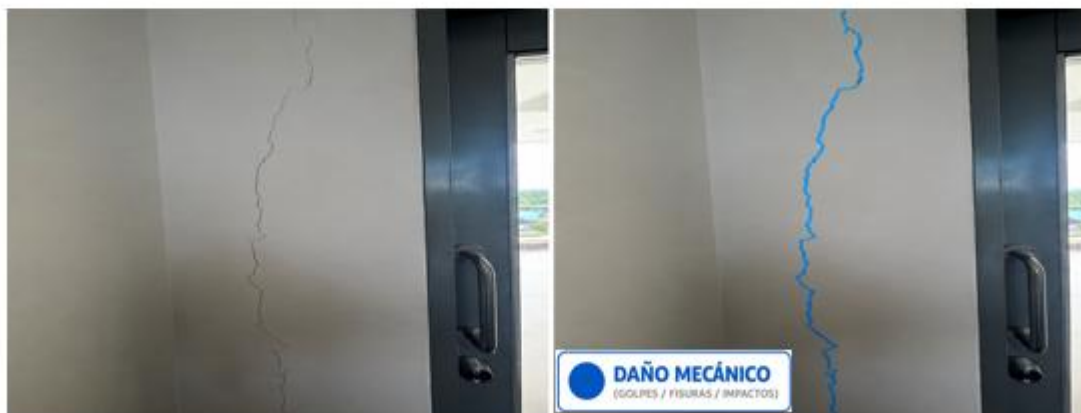
Figura 20. Grieta vertical en muro por deformación vertical (Universidad Santo Tomas, Villavicencio)
