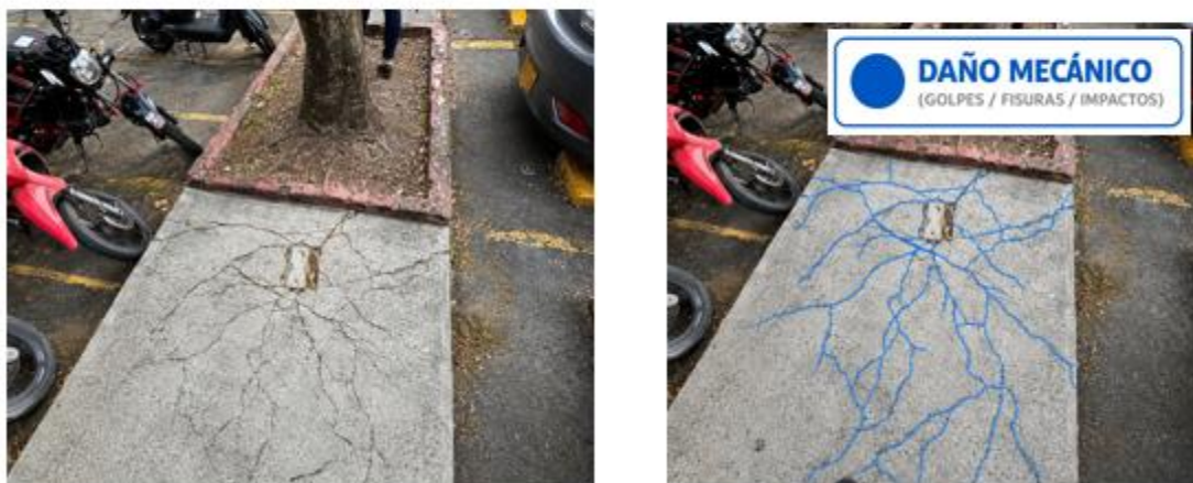
Figura 31. Patología grietas en jardines por raíces (Llano centro, Villavicencio)
