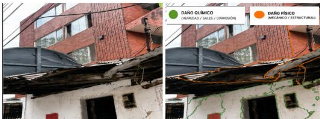
Figura 25. Patología deterioro de perlines de madera (Centro de Villavicencio)
