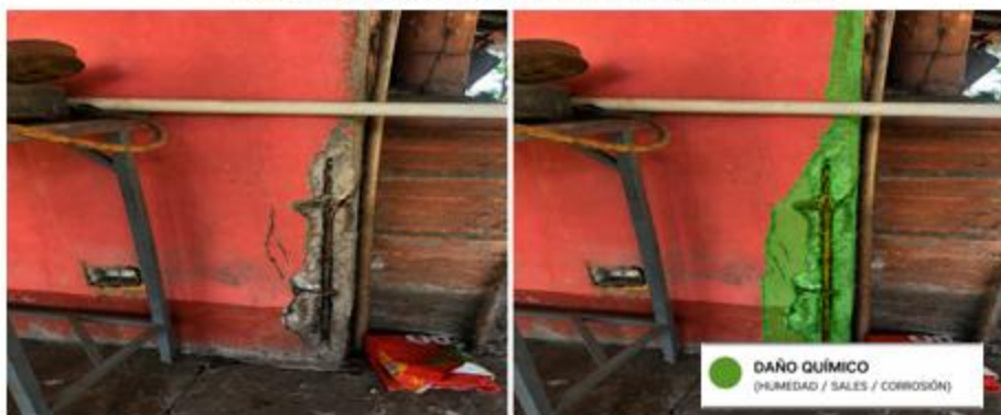
Figura 24. Patología corrosión del acero de refuerzo con desprendimiento de recubrimiento (Mani, Casanare)
