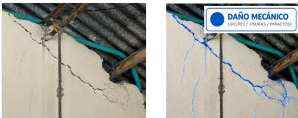
Figura 28 Patología daño fisuración en muro por movimiento estructural (La reserva, Villavicencio)
