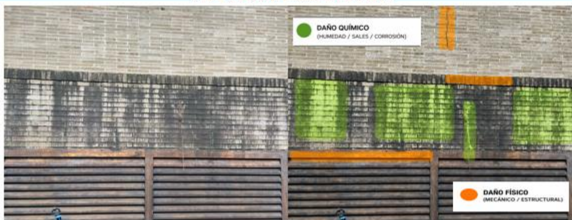
Figura 22. Patología humedad en muro de ladrillo por cristalización de sales (Primavera, Villavicencio)
