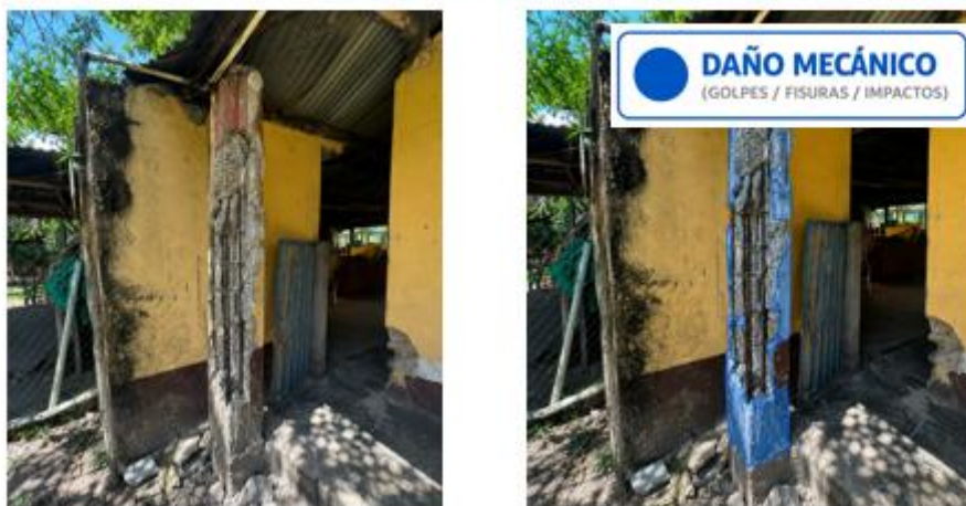
Figura 29. Patología daño estructural en columna de concreto (Mani, Casanere)
