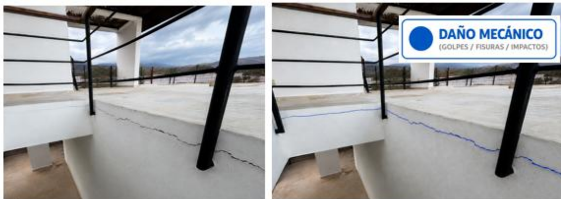
Figura 27 Patología grieta longitudinal en muro de concreto (La reserva, Villavicencio)
