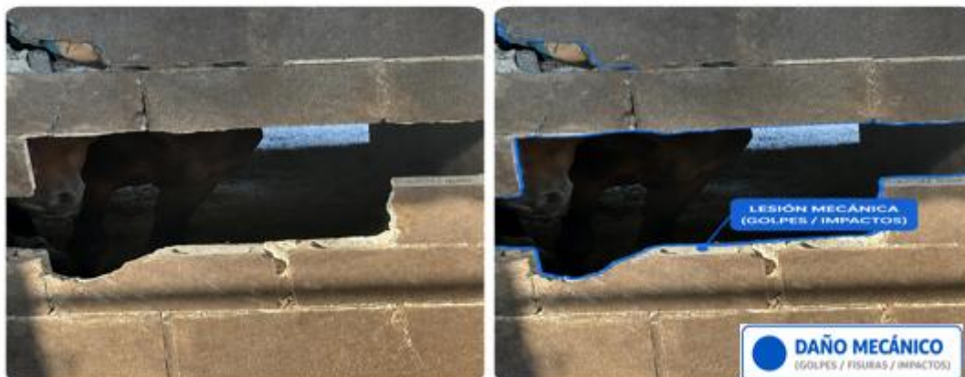
Figura 15. Patología fractura en muro de mampostería (La navarra, Villavicencio)
