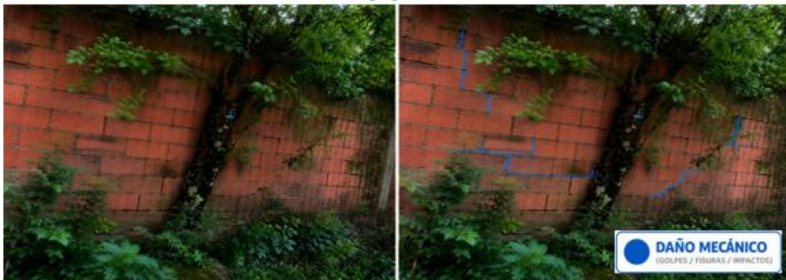
Figura 19. Patología grieta por oxidación de elemento (Playa rica, Villavicencio)
