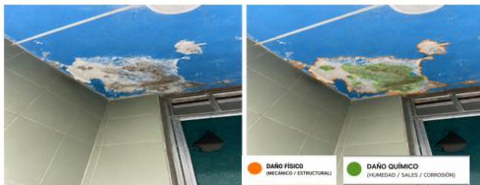
Figura 21. Patología de humedad de losa por filtraciones de agua lluvia (San Antonio, Villavicencio)
