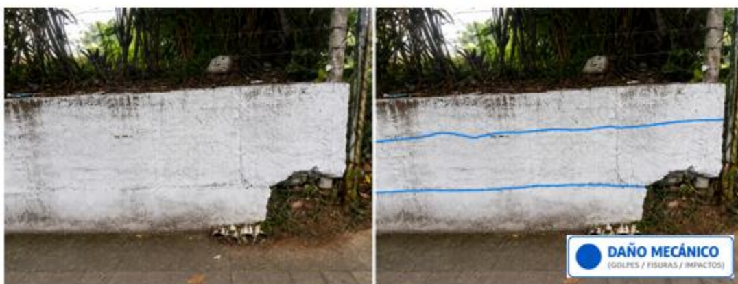
Figura 23. Patología grieta horizontal por empuje lateral del terreno (Villacentro, Villavicencio)
