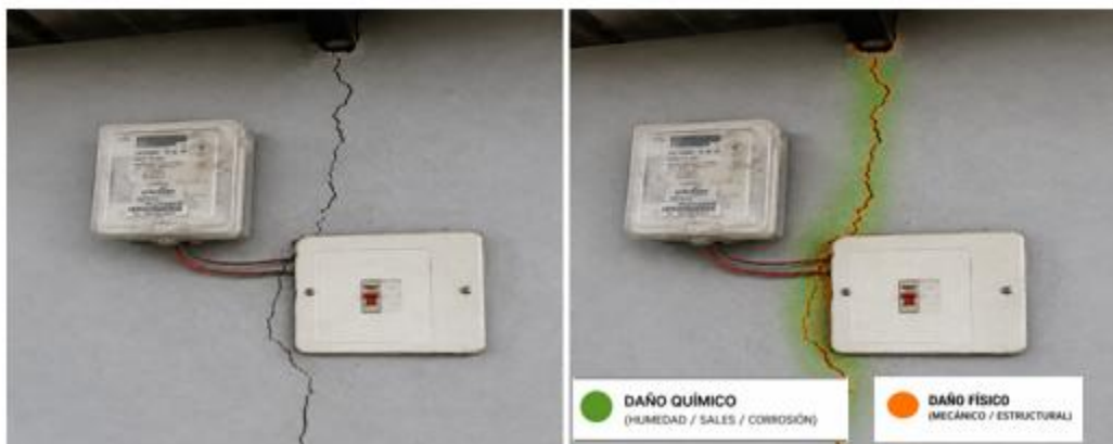
Figura 17. Patología grieta por oxidación de elemento (Playa rica, Villavicencio)
