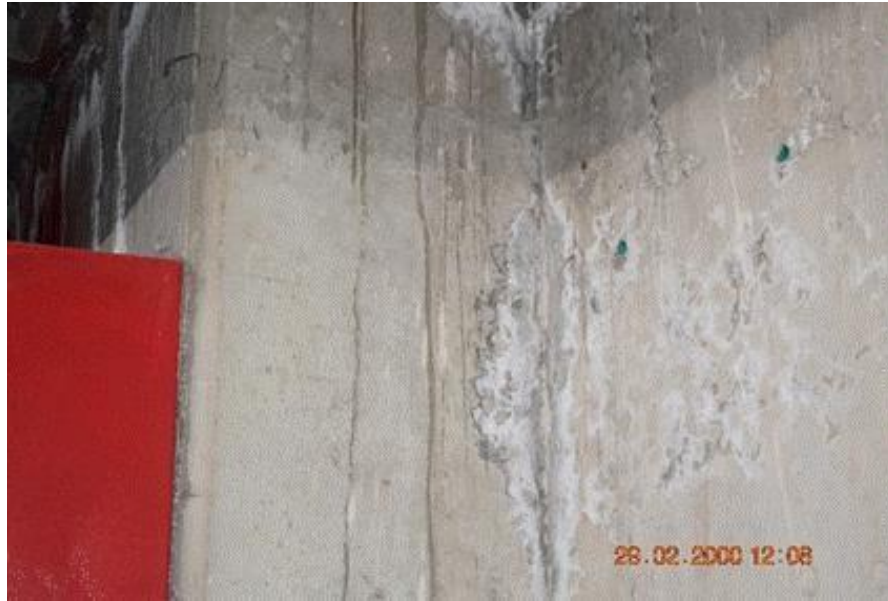
FIGURA 65. FALLA 13. FUENTE: PROPIA
