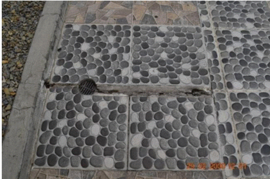
FIGURA 43. FALLA 2. FUENTE: PROPIA
