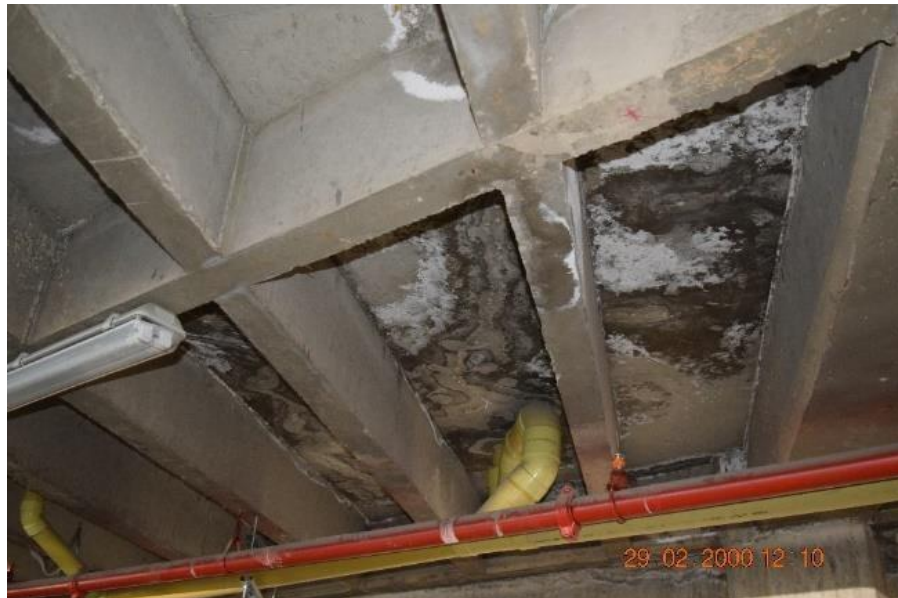
FIGURA 49. FALLA 5. FUENTE: PROPIA
