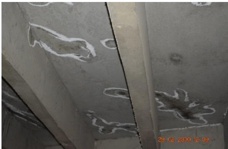
FIGURA 61. FALLA 11. FUENTE: PROPIA
