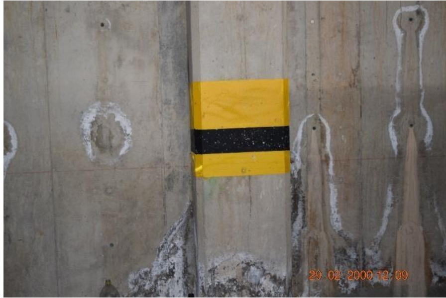
FIGURA 53. FALLA 7. FUENTE: PROPIA
