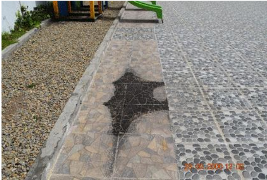
FIGURA 41. FALLA 1. FUENTE: PROPIA
