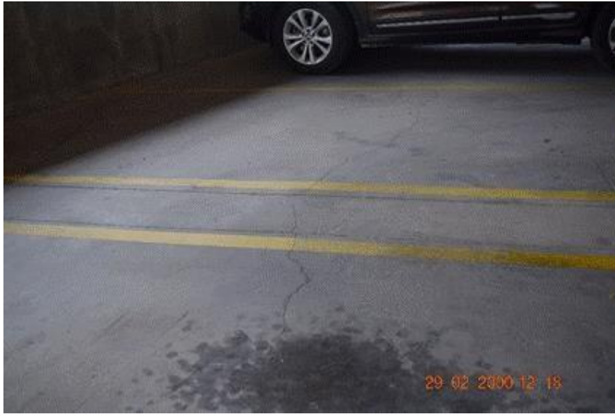
FIGURA 77. FALLA 19. FUENTE: PROPIA
