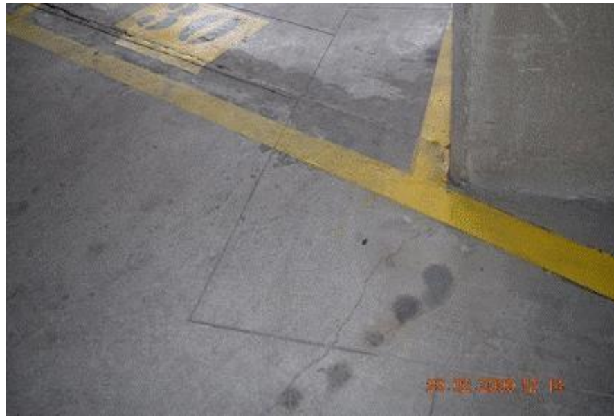
FIGURA 69. FALLA 15. FUENTE: PROPIA
