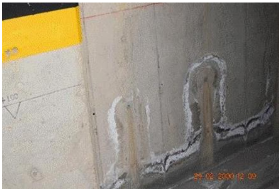
FIGURA 51. FALLA 6. FUENTE: PROPIA
