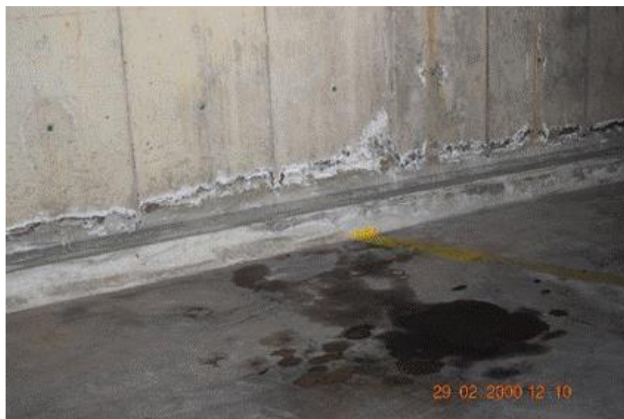
FIGURA 79. FALLA 20. FUENTE: PROPIA
