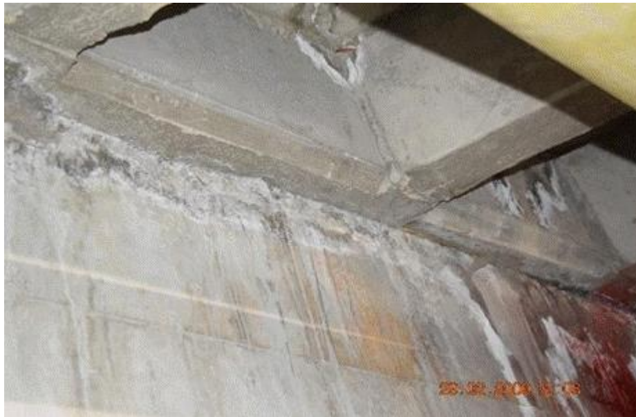
FIGURA 47. FALLA 4. FUENTE: PROPIA
