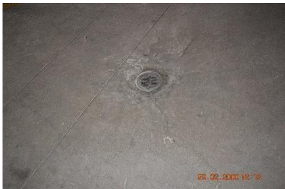
FIGURA 75. FALLA 18. FUENTE: PROPIA
