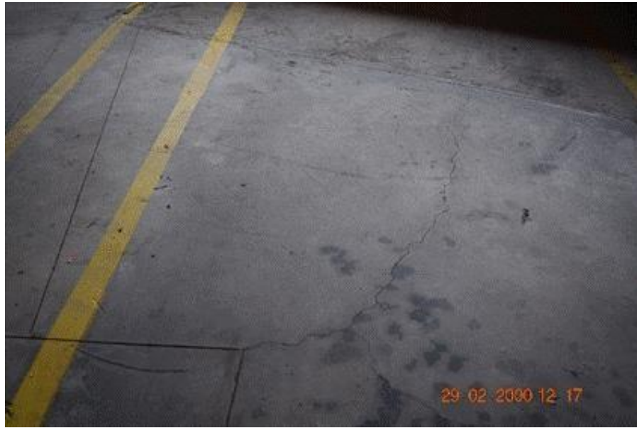
FIGURA 73. FALLA 17. FUENTE: PROPIA
