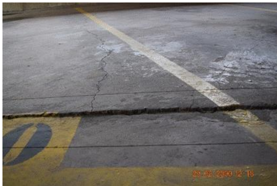
FIGURA 55. FALLA 8. FUENTE: PROPIA
