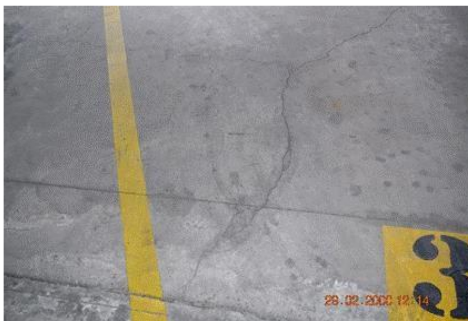
FIGURA 71. FALLA 16. FUENTE: PROPIA
