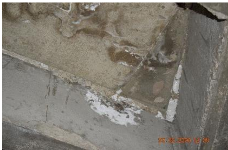
FIGURA 67. FALLA 14. FUENTE: PROPIA
