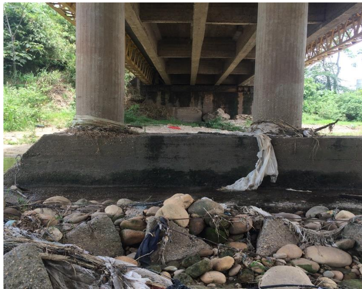
Fotografía 3.( Evidencia de Socavación en pila central – residuos de material arrastrado por el cauce- Puente Rio Ocoa )
