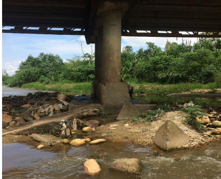
Fotografía 2.(Socavación local – playa en pila central – residuos de material arrastrado por el cauce)
