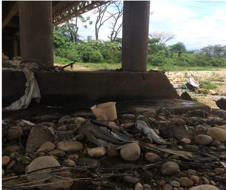
Fotografía 4.(Socavación pila centra costado lateral – residuos de material arrastrado por el cauce- Puente Rio OCoa) Autoría Propia
