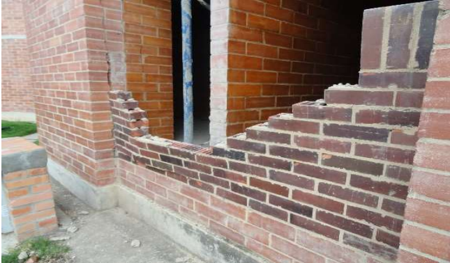
Foto N. 32. Desprendimiento de ladrillos en antepecho sin ventanería.
