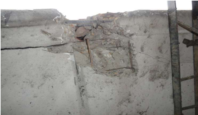
Foto N. 24. Vista de Acero de refuerzo expuesto por desprendimiento de concreto.
