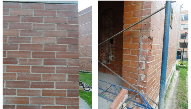
Foto N. 8. Falla en Muro de Mampostería.
