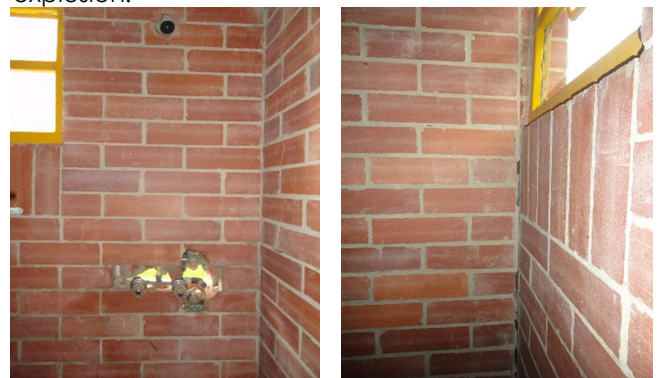
Foto N. 31. Instalación Hidrosanitaria afectada por explosión.
