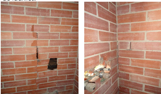
Foto N. 30. Falla en muro de mampostería, dilatación de ladrillos.
