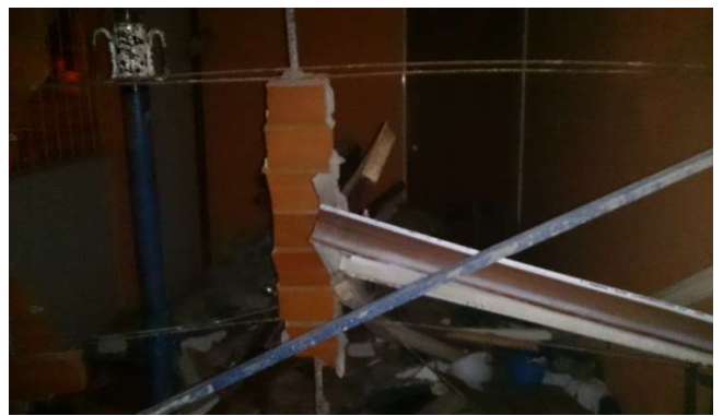
Foto N. 12. Pérdida total de muros estructurales
