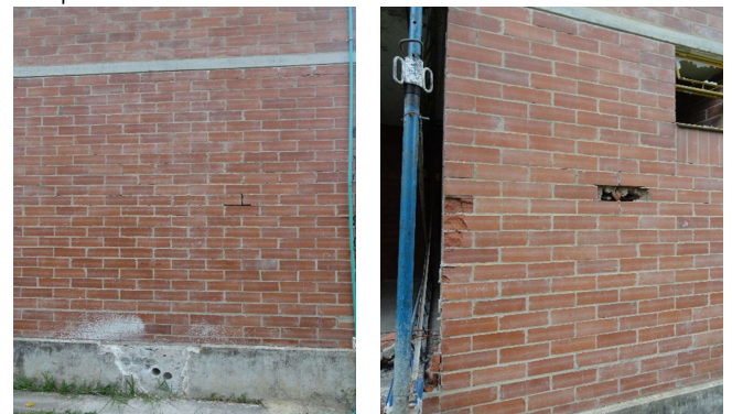
Foto N. 41. Falla de Muro con presencia de fisuras y desprendimiento de ladrillos
