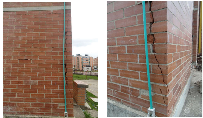
Foto N. 37. Desprendimiento de muro en esquina sur oriental.
