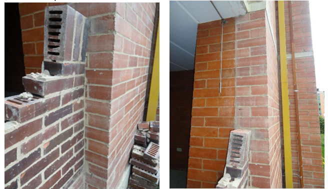
Foto N. 33. Desprendimiento de ventanería en muros de antepechos.
