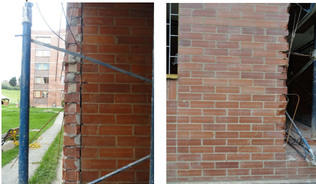
Foto N. 40. Muro afectado con presencia de fisuras y desprendimiento de ladrillos
