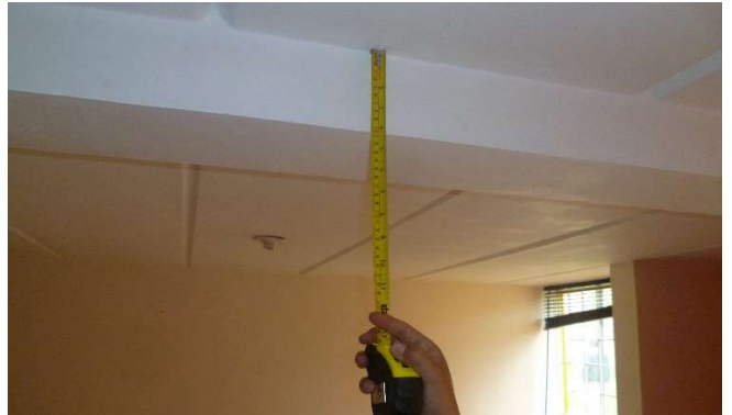
Foto N. 21. Viga descolgada en placa de entrepiso afectada.
