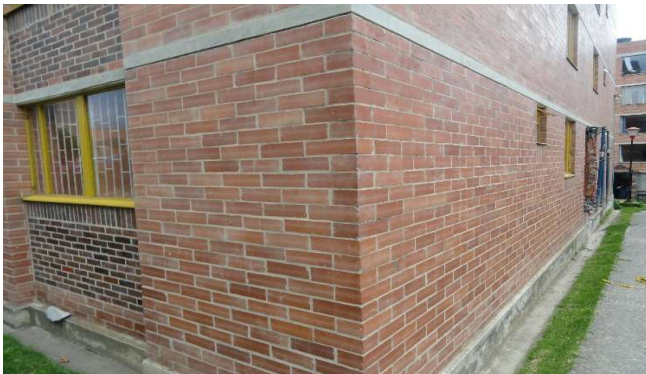
Foto N. 7. Fisuras en Muros de mampostería sector sur occidental.
