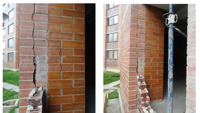
Foto 43. Falla en muro adosado a muro antepecho
