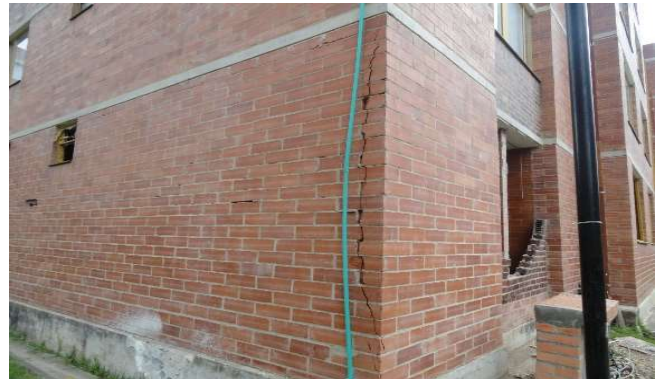
Foto N. 39. Falla de muro por onda expansiva.
