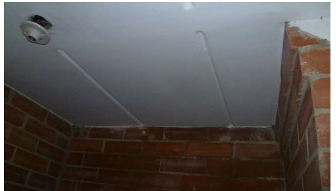
Foto N. 23. Fisuración en placa de entrepiso.
