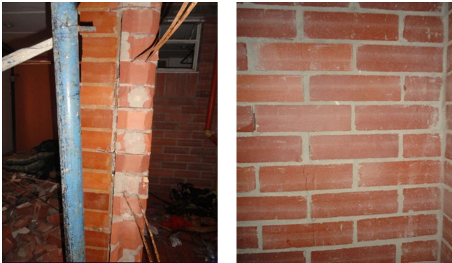
Foto N. 28. Pérdida de dovela reforzada en muro estructural.
