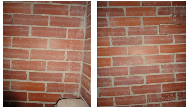
Foto N. 29. Falla en muro de mampostería, dilatación de ladrillos.
