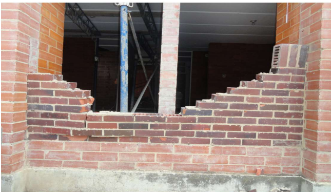
Foto 34. Pérdida de ladrillos en muro no estructural.
