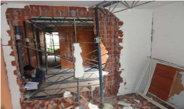
Foto N. 18. Vista Interna de Apto afectado
