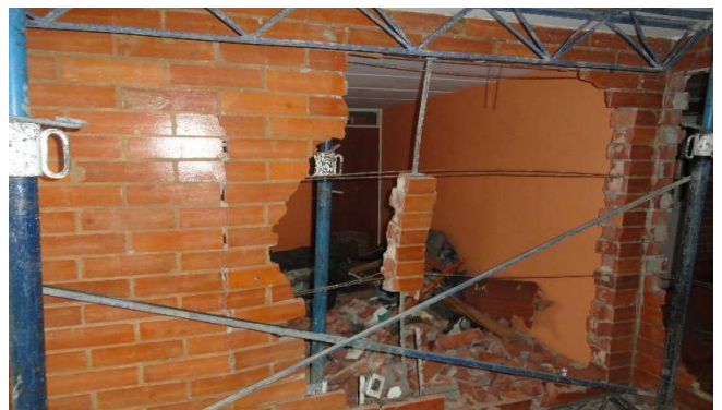
Foto N. 19. Muro abombado y Agrietado.
