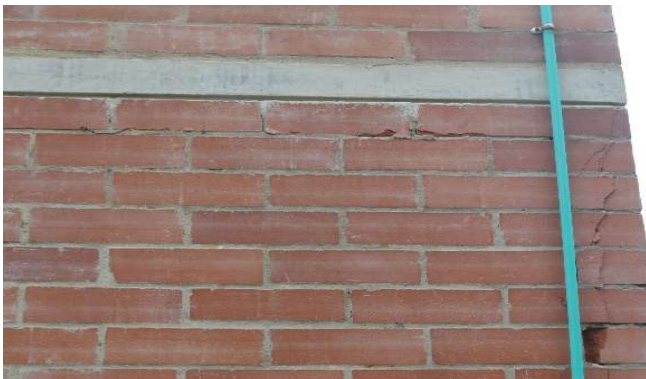
Foto N. 38. Grietas en muro en mampostería.
