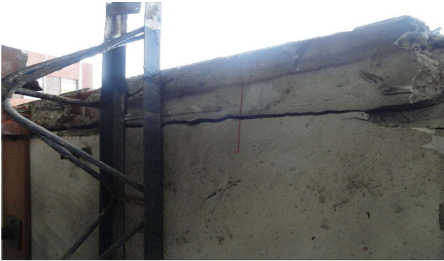
Foto N. 22. Agrietamiento en placa de entre piso.
