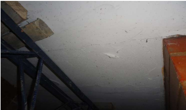
Foto N. 20. Placa de entrepiso fisurada.
