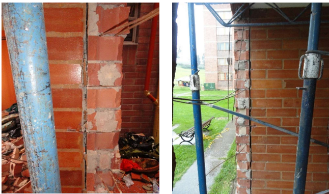
Foto 20. Desprendimiento de muro en mampostería.
