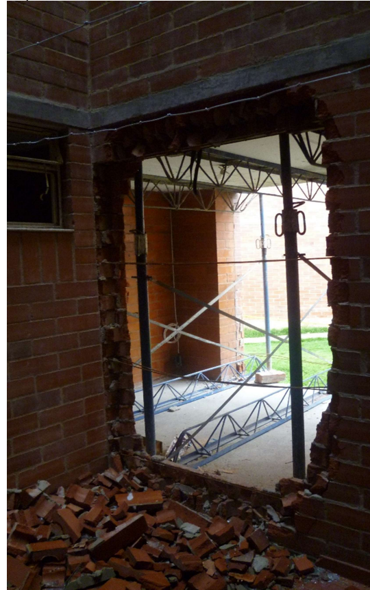
Foto N. 16. Muro derrumbado afectado por explosión.
