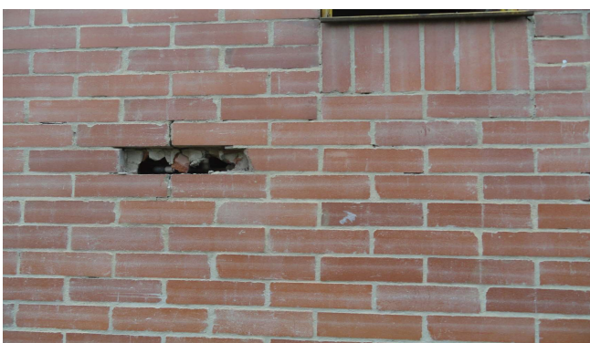
Foto N. 42. Desprendimiento muro en mampostería.
