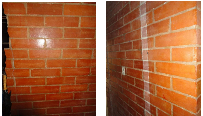
Foto N. 27. Fisuración en muro den mampostería.
