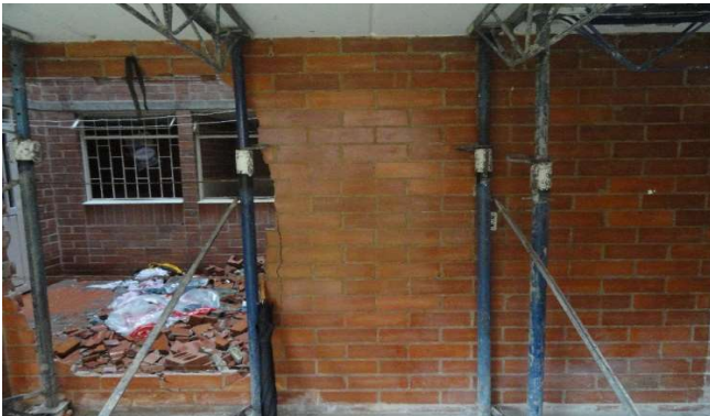
Foto N. 13. Pérdida total de muro estructural.
