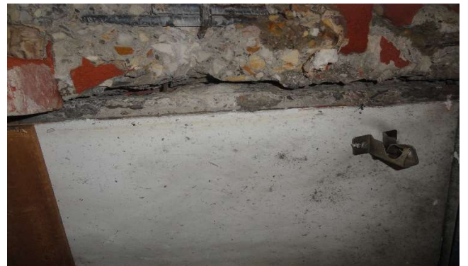
Foto N. 25. Desprendimiento de pre losa de concreto.
