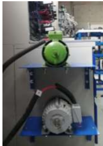
Figura 72. Plataforma motores trifásicos
