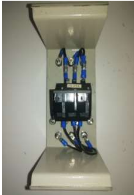
Figura 44. Estado antiguo de los elementos de sujeción.
