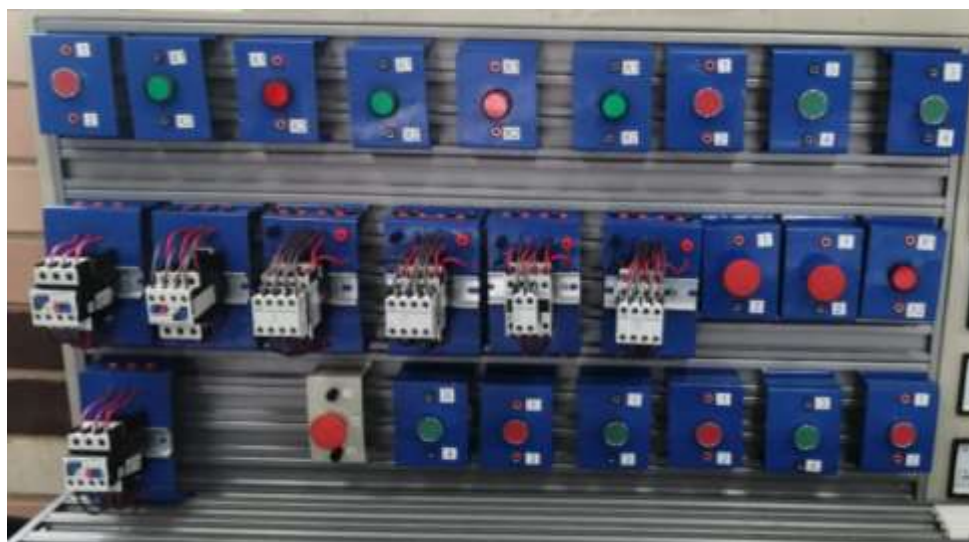
Figura 79. Nuevos accionamientos eléctricos
