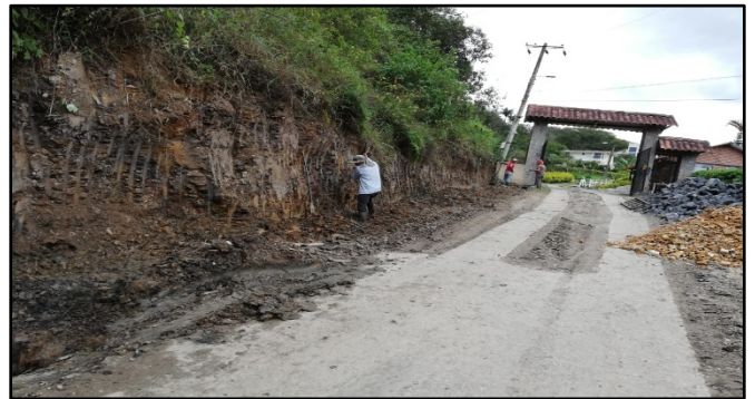
Imagen 8. Deslizamiento del talud
