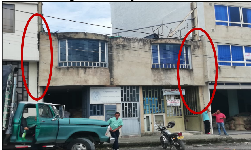
Imagen 13. Patologías de viviendas
