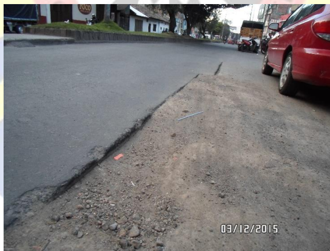
Imagen 6. Hundimiento en sentido longitudinal, calzada 1. Fuente: Este trabajo.
