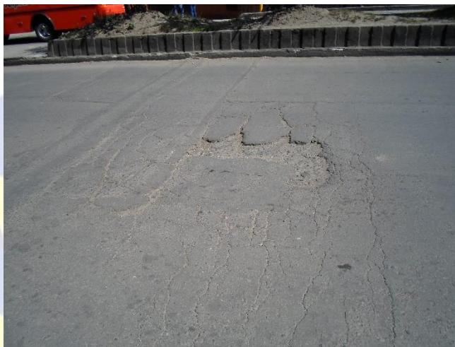
Imagen 7. Descascaramiento en calzada 2. Fuente: Este trabajo.
