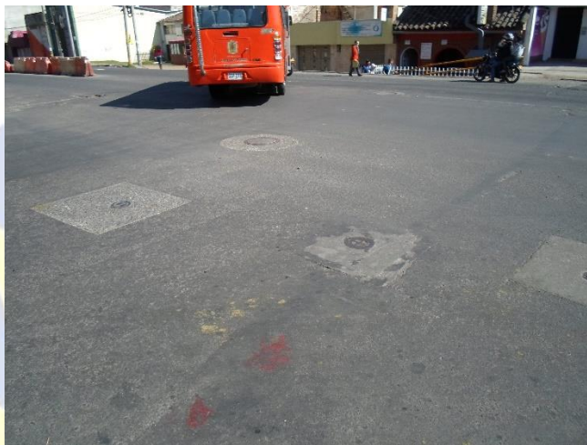
Imagen 10. Desgaste superficial de la carpeta de rodadura. Fuente: Este trabajo.
