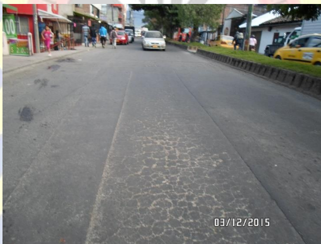
Imagen 9. Parche con presencia de piel de cocodrilo. Fuente: Este trabajo.
