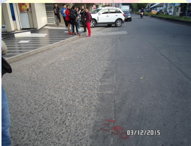
Imagen 3. Fisura de construcción longitudinal. Fuente: Este trabajo.
