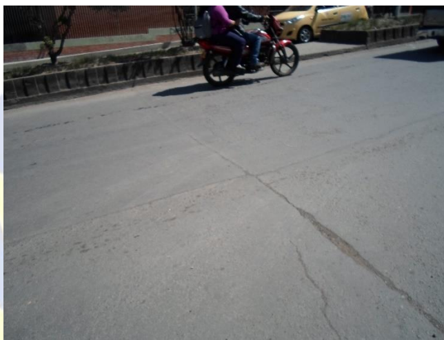
Imagen 2. Fisura transversal. Fuente: este trabajo.
