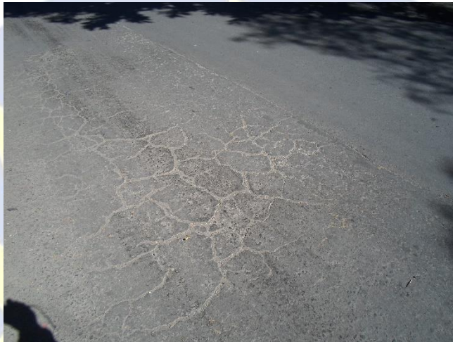
Imagen 4. Fisuras en bloque en la calzada 2. Fuente: Este trabajo.
