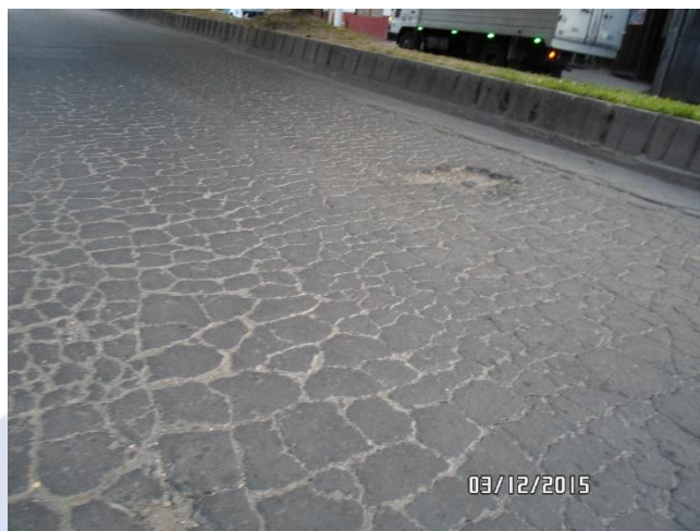
Imagen 5. Piel de cocodrilo en calzada 1. Fuente: Este trabajo.
