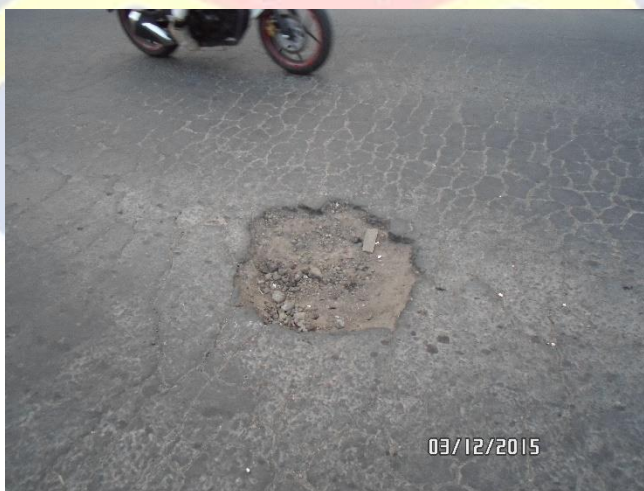
Imagen 8. Bache en la calzada 1. Fuente: Este trabajo.
