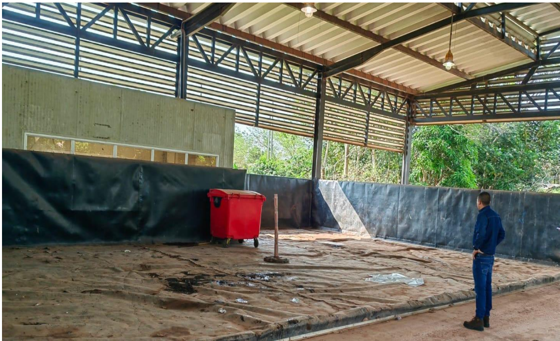
Fig 3. Fotografía planta de ensilaje previo a la adecuación
