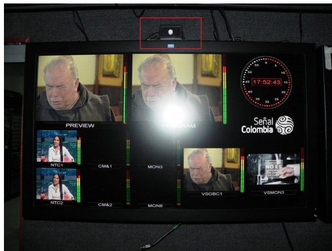
Fig. 16 Cajas de circuitos montadas en los monitores
