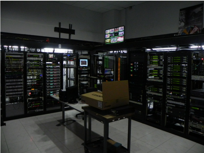
Fig. 1 Cuarto de equipos de master de emisión
