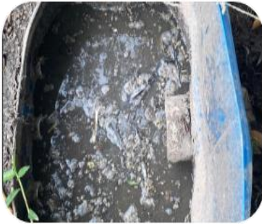
Arqueta de distribución
