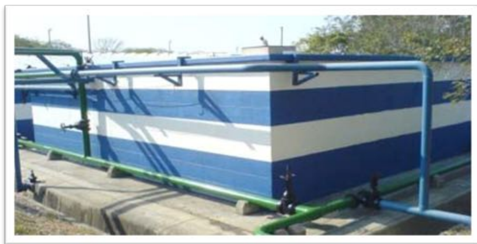
Figura 2 Tanque de almacenamiento de agua potable superficial, imagen fuente www.raconstrusoluciones.com .
