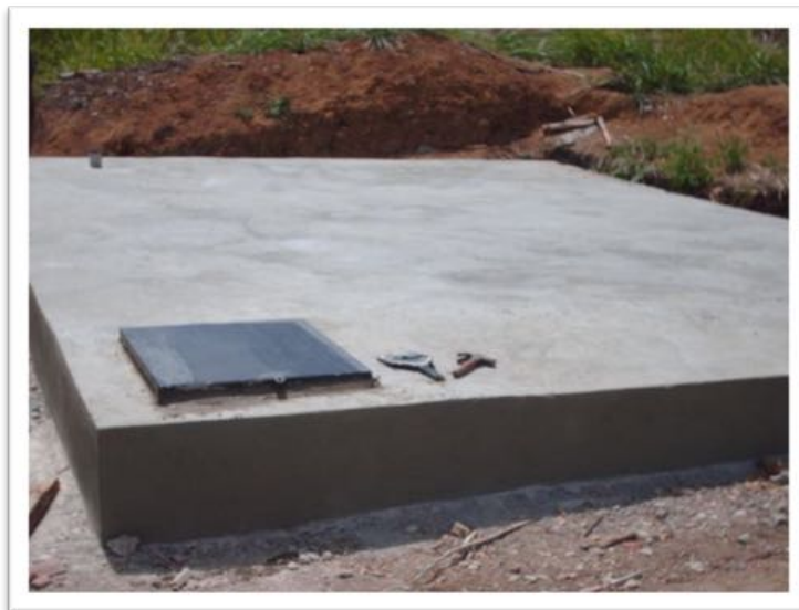
Figura 3 Tanque de almacenamiento de agua potable enterrado, imagen fuente www.acamy.com.ve .
