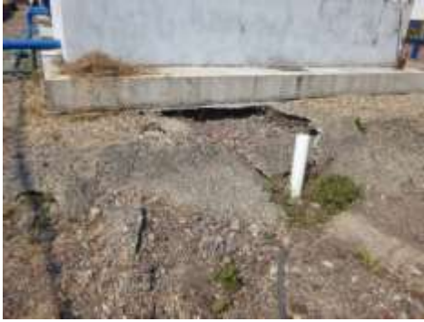
Figura 14 Suelo inestable PTAP La Reliquia.
