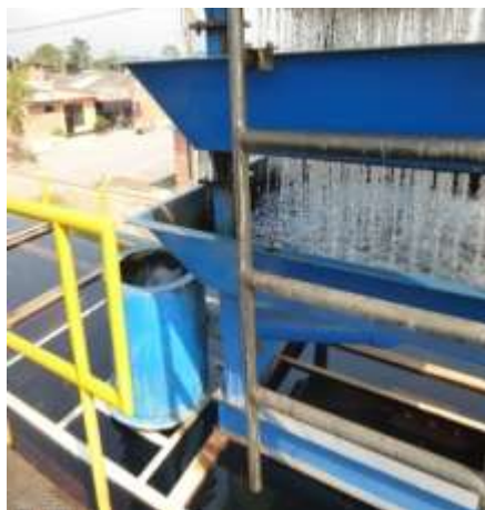
Figura 13 Torre de aireación PTAP La Reliquia. María Carrillo, 2019
