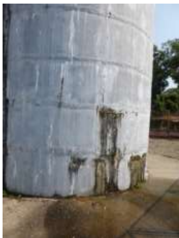
Figura 12 Fisuras en el tanque de almacenamiento PTAP La Reliquia. María Carrillo, 2019
