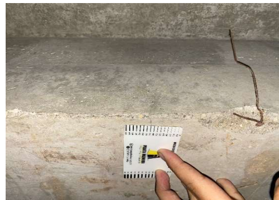
Foto 2. Fisura en viga VG-4 sótano 2
