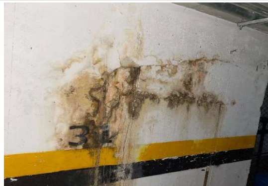
Foto 2. Muro afectado por humedad sótano 2
