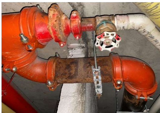
Foto 2. Corrosión tubería RCI sótano 2
