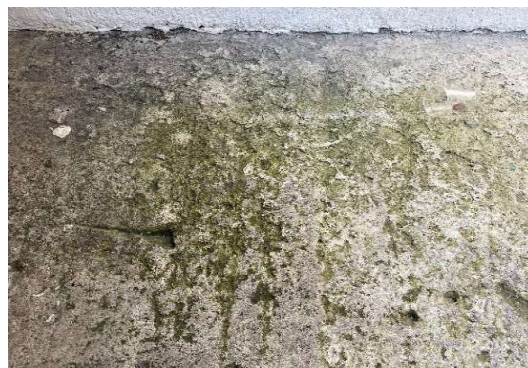
Foto 2. Placa parqueaderos nivel +1,25 piso 1
