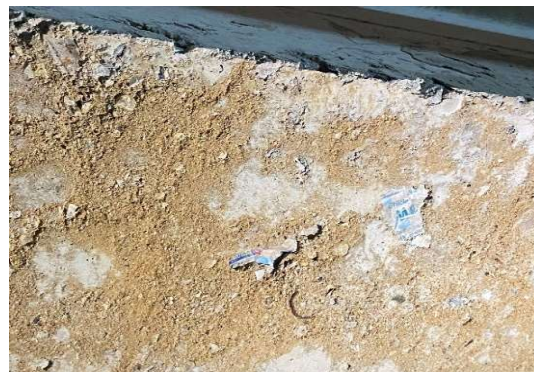
Foto 2. Material no íntegro Viga VDE sótano 2
