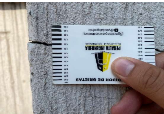
Foto 2. Muro no estructural parque infantil
